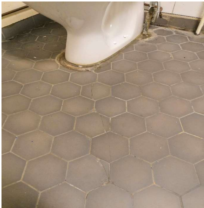
Kuva 14. Wc:n kaakeleiden halkeilua.
