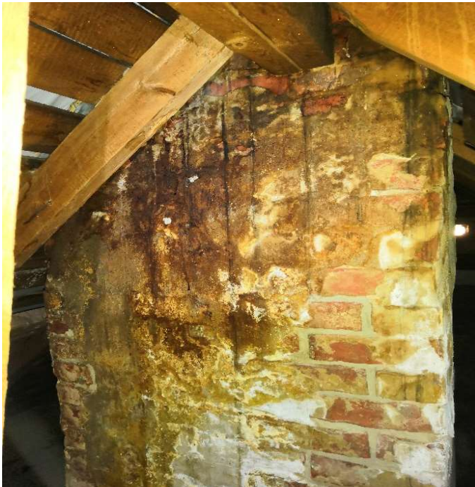
Kuva 26. Hormin läpiviennin vuodot.
