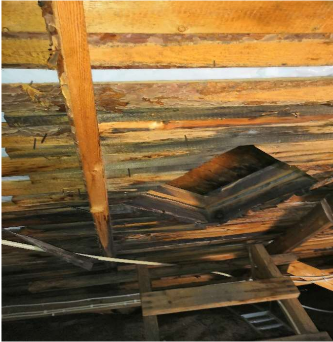
Kuva 15. Kosteus jälkiä kattorakenteissa.
