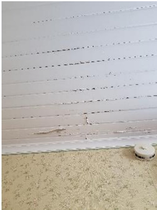
Kuva 22. Katossa on kosteuden aiheuttamaa hilseilyä.
