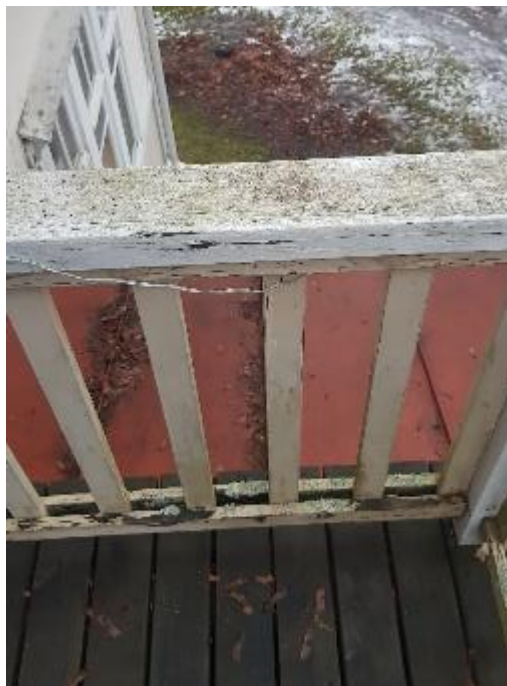
Kuva 10. Parvekekaide on huonossa kunnossa.
