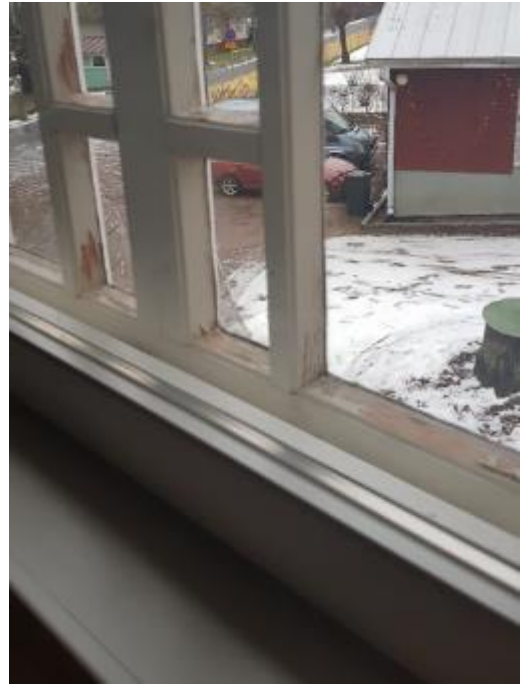
Kuva 12. Myös ikkunoiden välissä oleva maali on hilseillyt.
