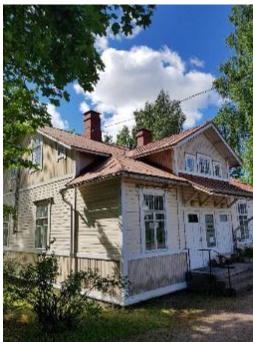
Kuva 4. Rikkinäiset sadevesikourut kastelevat seinän.
