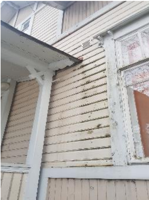
Kuva 18. Vesi pääsee valumaan seinälle.
