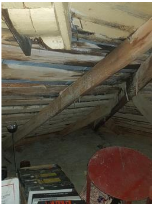
Kuva 20. Laajennuksen jiiri on pahin vuoto kohta.
