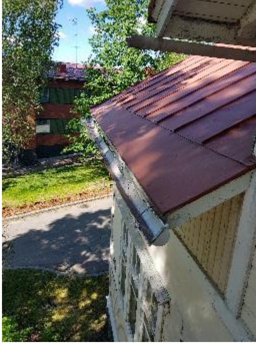
Kuva 16. Katto vuotaa vaakasaumasta.
