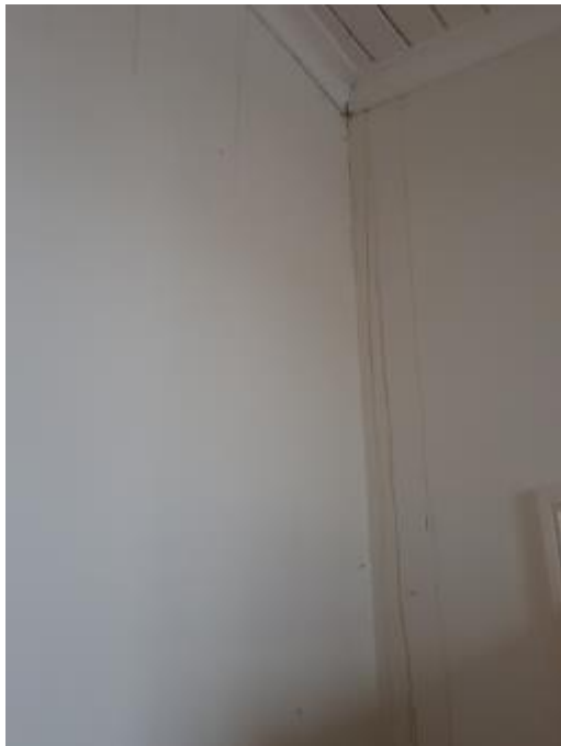
Kuva 24. Lipunmyyntihuoneen seinässä olevat valumajäljet.
