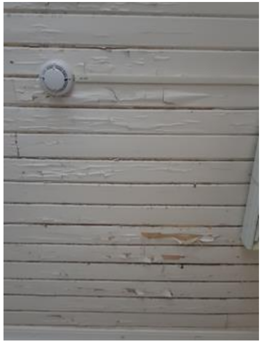
Kuva 23. Lipunmyyntihuoneessa olevat pahimmat vuotokohdat.
