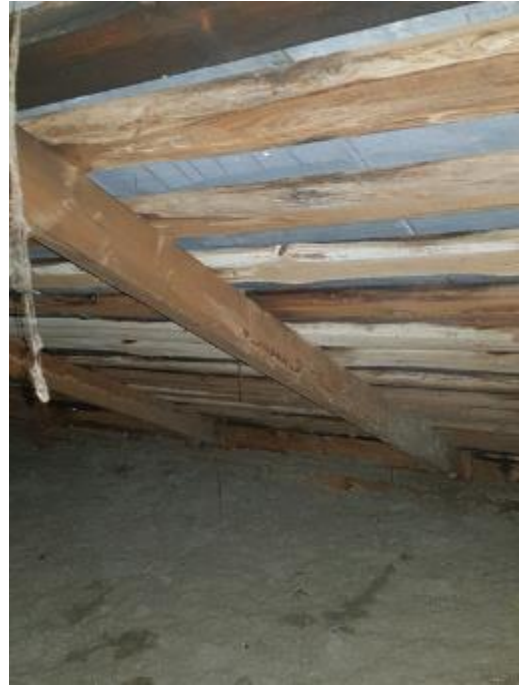
Kuva 19. Vesi pääsee tihkumaan eristeisiin.
