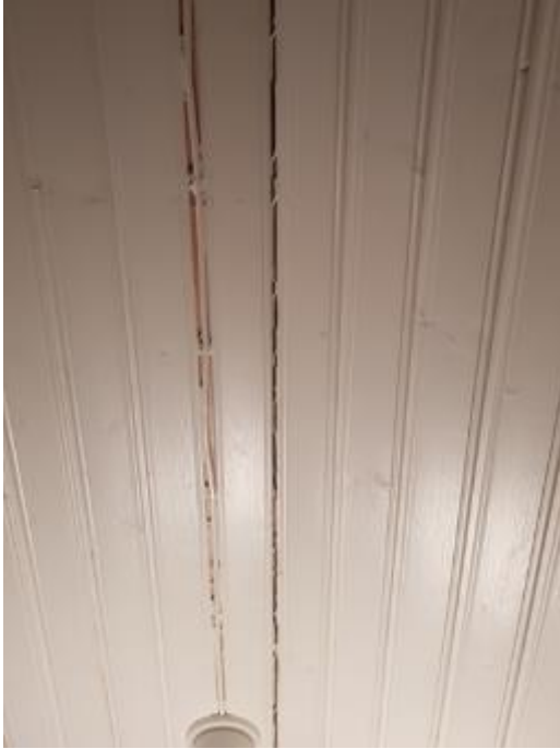
Kuva 28. Katossa on jälkiä kosteuden elämisestä.
