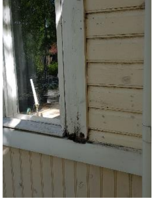
Kuva 8. Ikkunan peitelauta ja poikki puu ovat lahoja.
