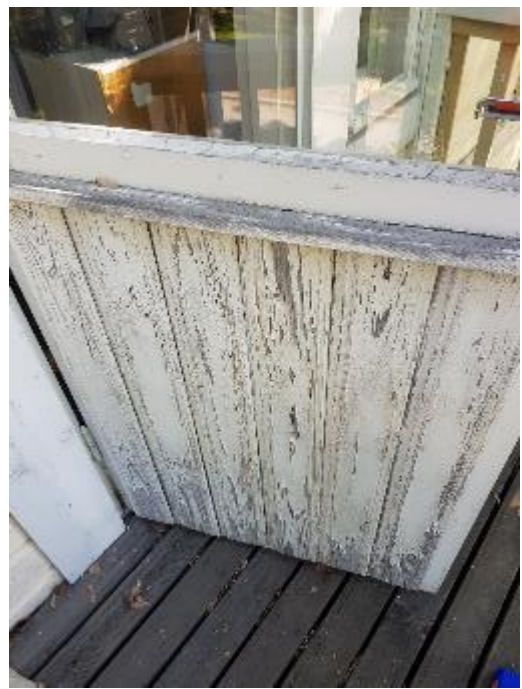
Kuva 14. Parvekkeen oven maali on hilseillyt.
