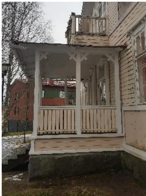
Kuva 9. Sisäänkäyntikatoksen ruode- ja ot-salautat ovat lahonneet.
