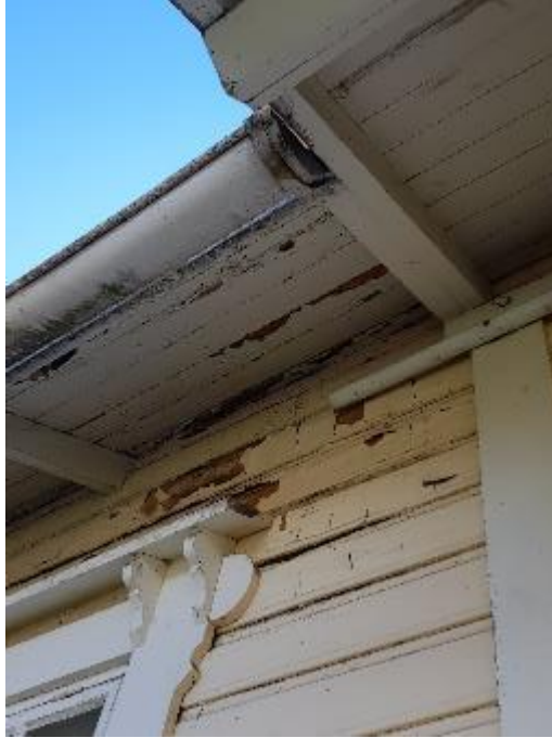
Kuva 7. Katon vuoto on lahottanut myös julkisivua.
