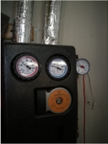
KUVA 18. Aurinkokeräimien lämpömittarit ja kiertovesipumppu
