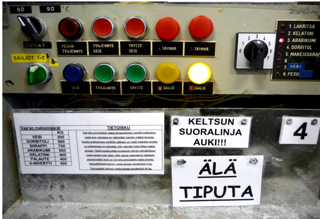
Kuva 5. Annostelupaneeliin tehty parannus.
