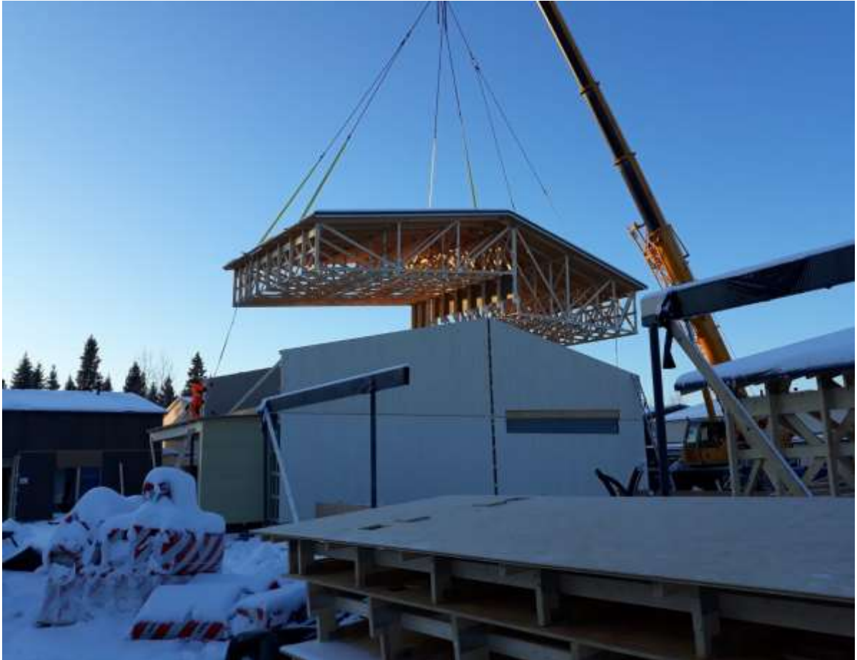
KUVA 6. Katto asennetaan seinien päälle heti pystytyksen jälkeen, jotta kuiva- ketju ei katkea
