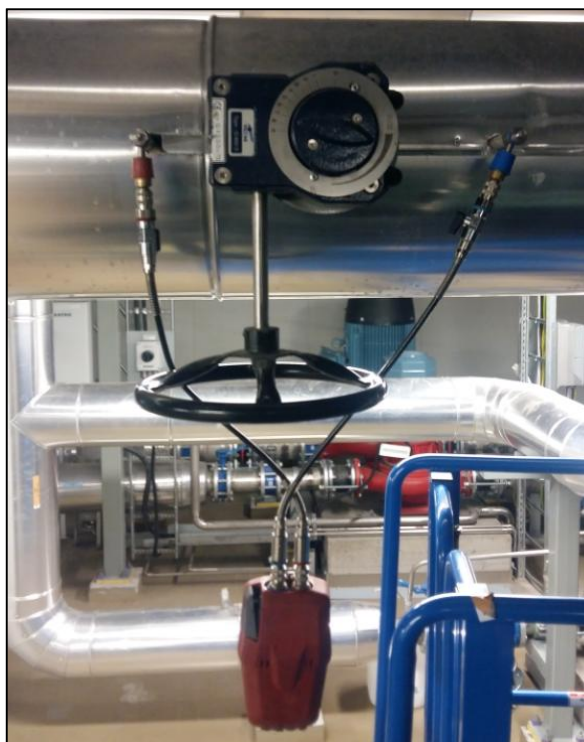
Kuva 22. Paine-eromittari linjasäätöventtiin mittaussyhteissä.
