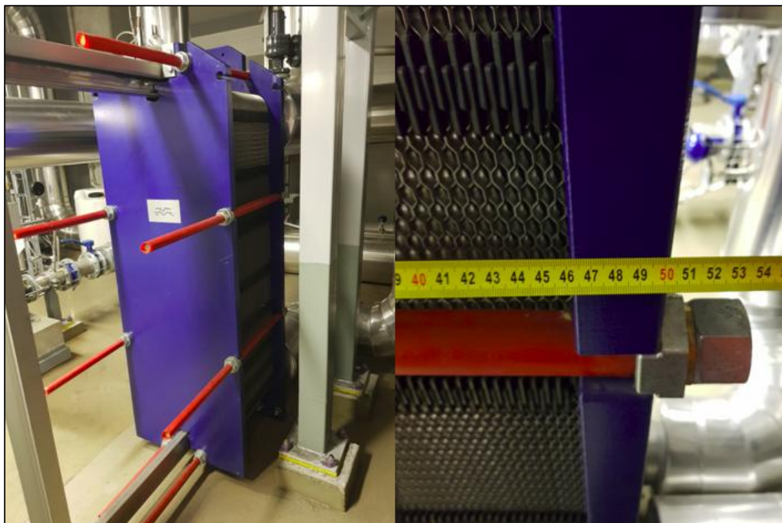
Kuva 20. Matalalämpöverkoston lämmönsiirrin LS1.
