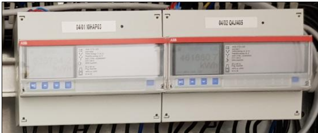
Kuva 24. Osa pääkeskuksessa sijaitsevistä sähköenergiamittareista.
