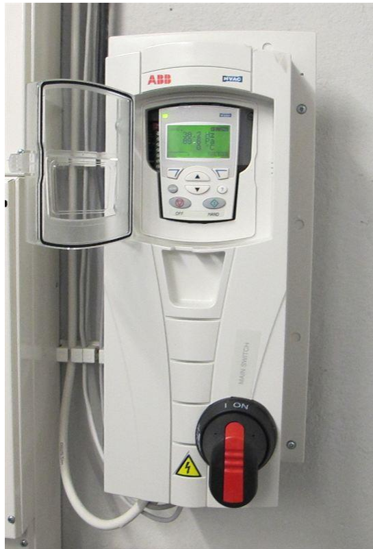
Kuva 2. Compact Eco -taajuusmuuttaja asennettuna
