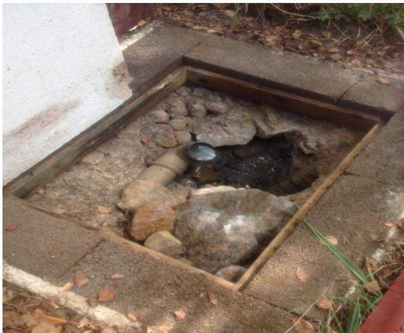
Kuva 12. Harmaiden jätevesien imeytyspiste (Lindström 2018)
