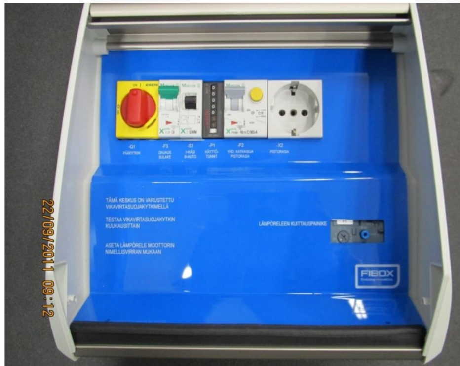
Kuva 16. Yhden pumpun sähkökeskus (Grundfos n.d.r.)
