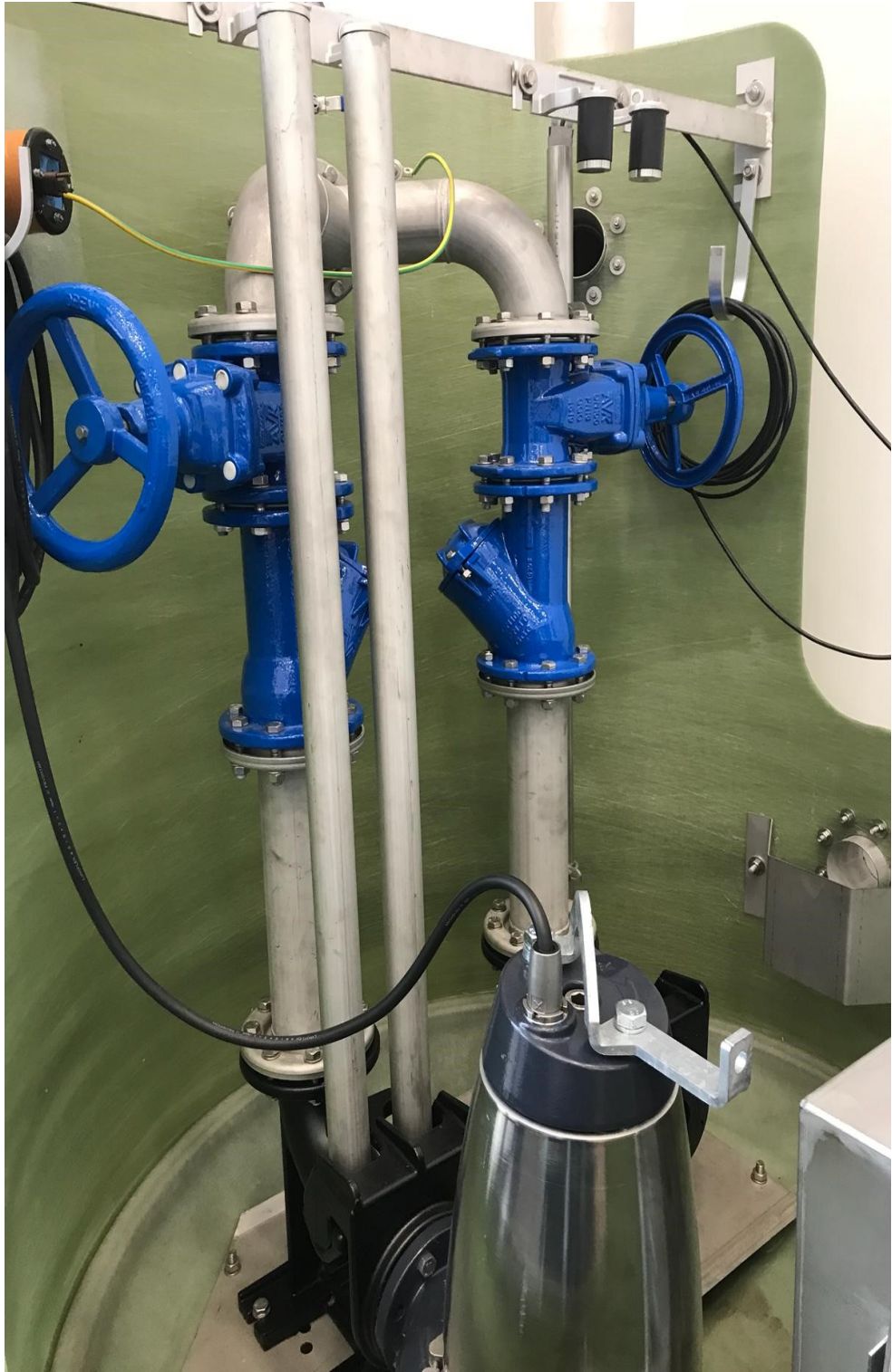
Kuva 22. Pumppaamo sisältäpäin (Vannula 2019.)
