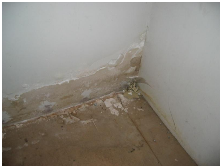
KUVIO 1. Mikrobikasvustoa tutkittavan tilan seinissä ja lattiassa (ISS Proko Oy)
