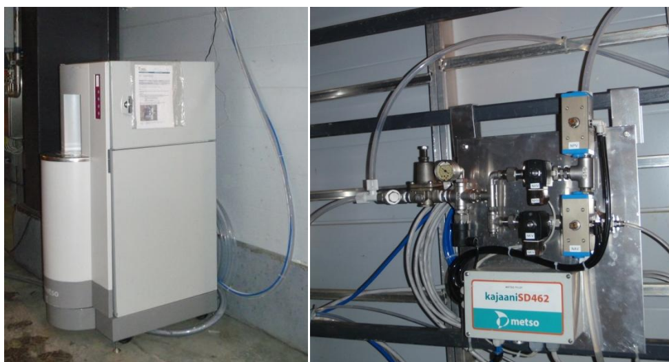
Kuva 11. Analysaattori ja näytteenotin asennettuna Talvivaaran metallien talteenottolaitok- selle.
