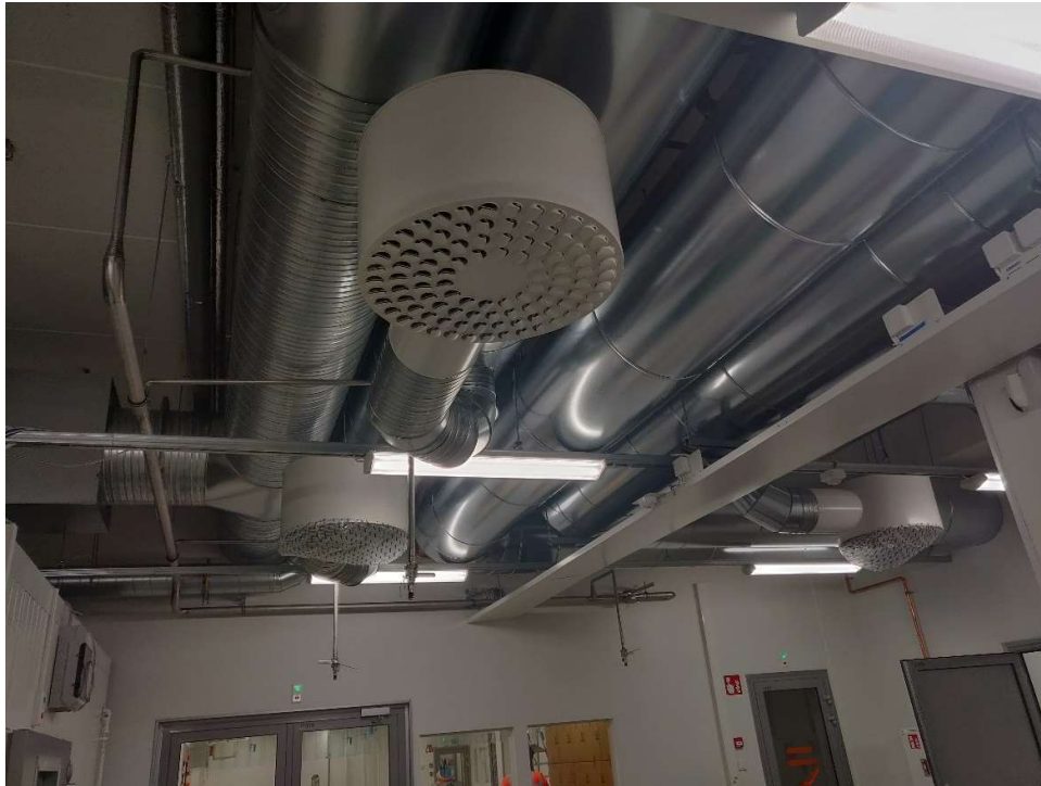
Kuva 8. Puhdastiloja palvelevaa ilmastointikanavaa.
