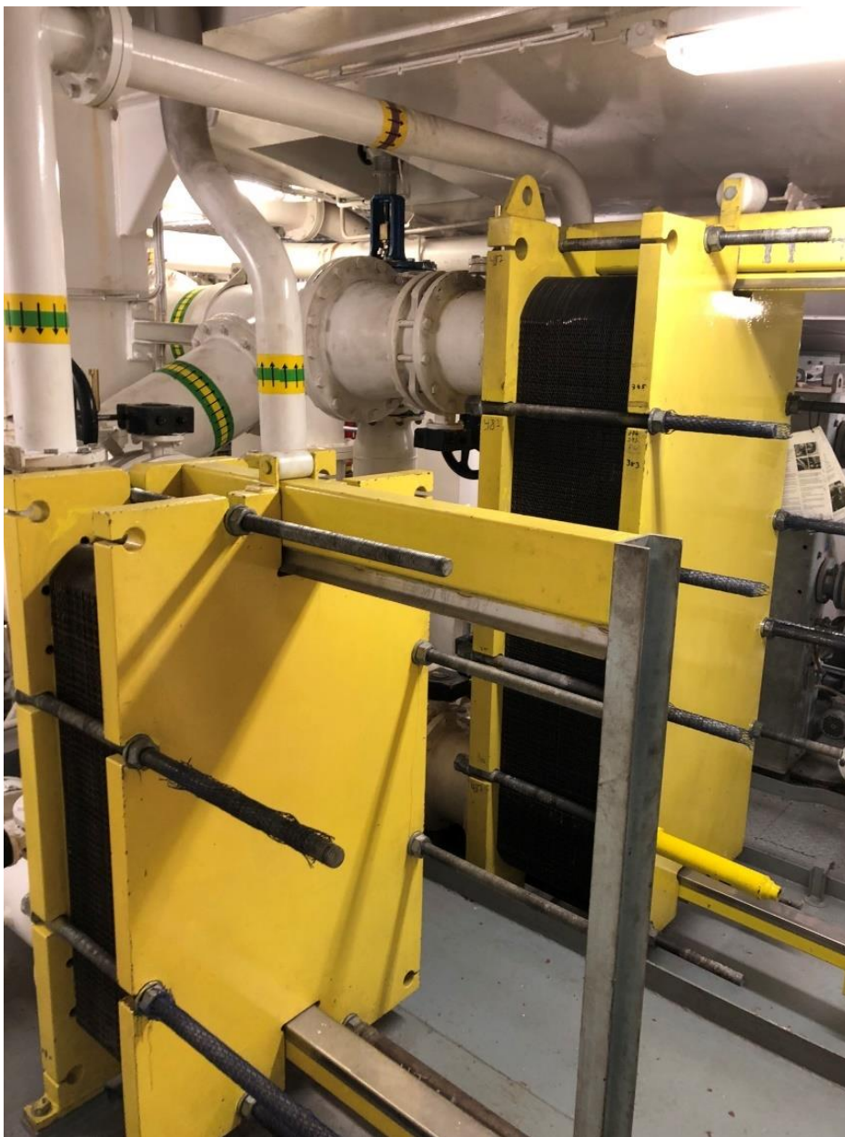
Kuva 21. Pienempi levylämmönvaihdin HT-veden jäähdytykseen ja suurempi LT-veden jäähdytykseen.
