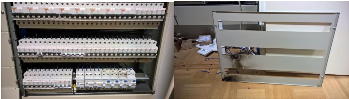
Kuva 4 Valokaari, joka on syntynyt keskuksen kannen ja johdonsuojan jännitteisen ruuvien välille.
