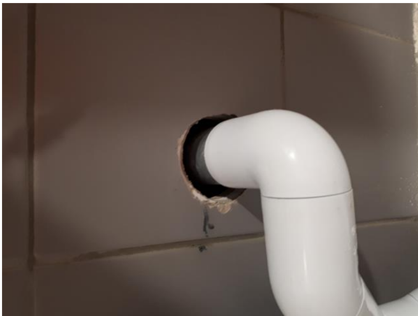
Kuva 9. Tyypillinen viimeistelytyöhön liittyvä virhe. Putkiläpivientä ei ole massattu.
