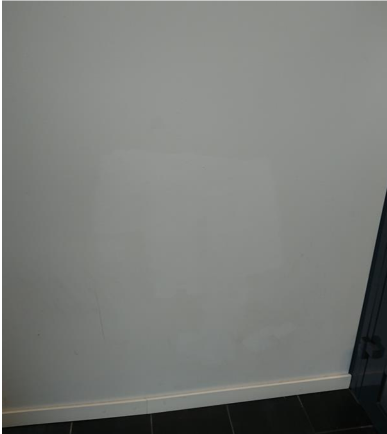
Kuva 7. Seinän väärä värisävy tulee ilmi korjausmaalaamisessa
