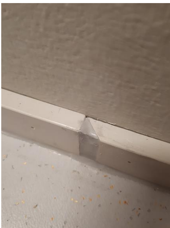
Kuva 10. Tyypillinen viimeistelytyöhön liittyvä virhe. Jalkalistaa on jatkettu massalla.
