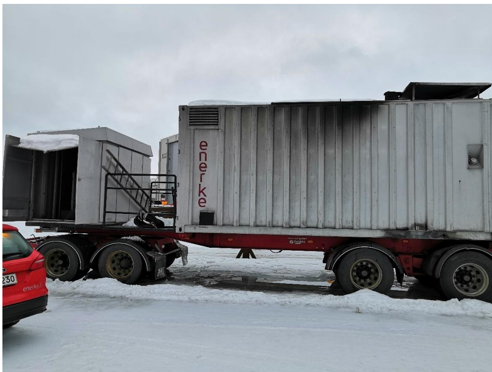
KUVA 2. 1000 kVA varavoimakone kontissa, vasemmalla muuntaja
