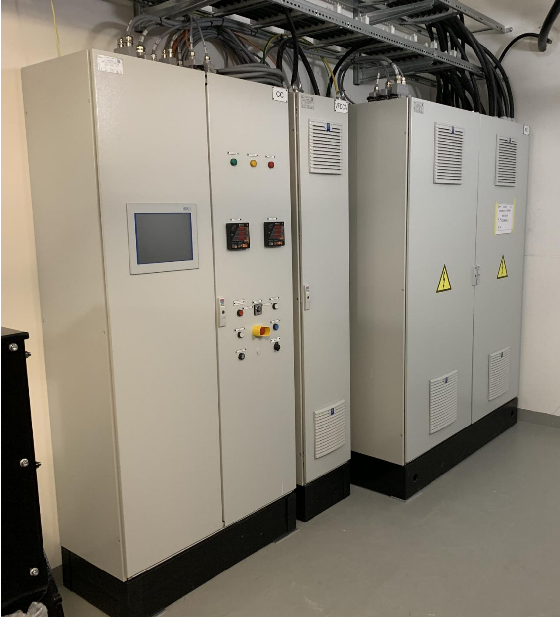
KUVA 9. CC-, VFDC- sekä PC -kaapit kohteessa
