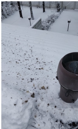
Figur 14. Damm som lossnat efter rengöringen av takfläkt på radhus i Lojo. Bild Simon Wickström, 04.02.2018.
