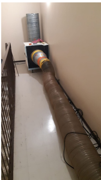
Figur 9. En undertrycksfläkt med inbyggt filter. Bild: Rasmus Hellström, 2.4.2019.
