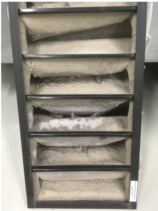
Figur 1. Smutsigt filter i ventilationsaggregatet. Bild: Sebastian Alfthan, 27.4.2019.
