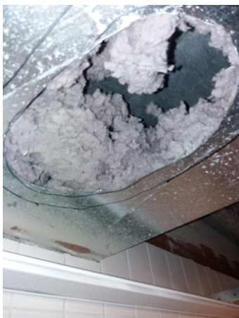
Figur 38. Frånluftskanal där textilfiber kommit från ett torkskåp till ventilationskanalen. Bild: Rasmus Hellström, 3.4.2018.
