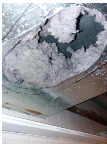
Figur 8. Smutsig frånluftskanal. Bild: Rasmus Hellström, 14.4.2019.
