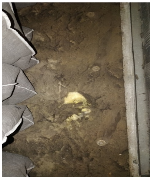
Figur 13. Filtren i ventilationsaggregat har inte varit täta och därför släppt igenom smuts. Mineralullens yta är också skadad och ullfiber lösgörs till tilluften. Bild: Simon Wickström, 28.02.2019.
