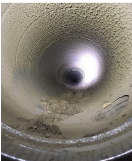
Figur 3. Figur 3 är från en frånlufts kanal dit duschutrymmens frånluft leds. Damm har fastnat på kanalytan. Bild: Sebastian Alfthan, 28.08.2018. Operahuset i Helsingfors.
