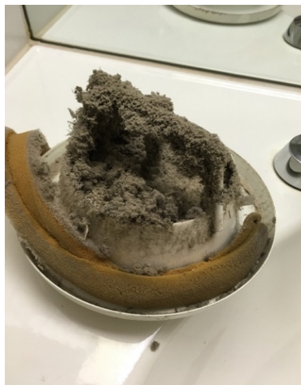
Figur 4. Frånluftsventilen i figur 4 är från duschutrymmet. Bild: Sebastian Alfthan, 28.08.2018. Operahuset i Helsingfors.
