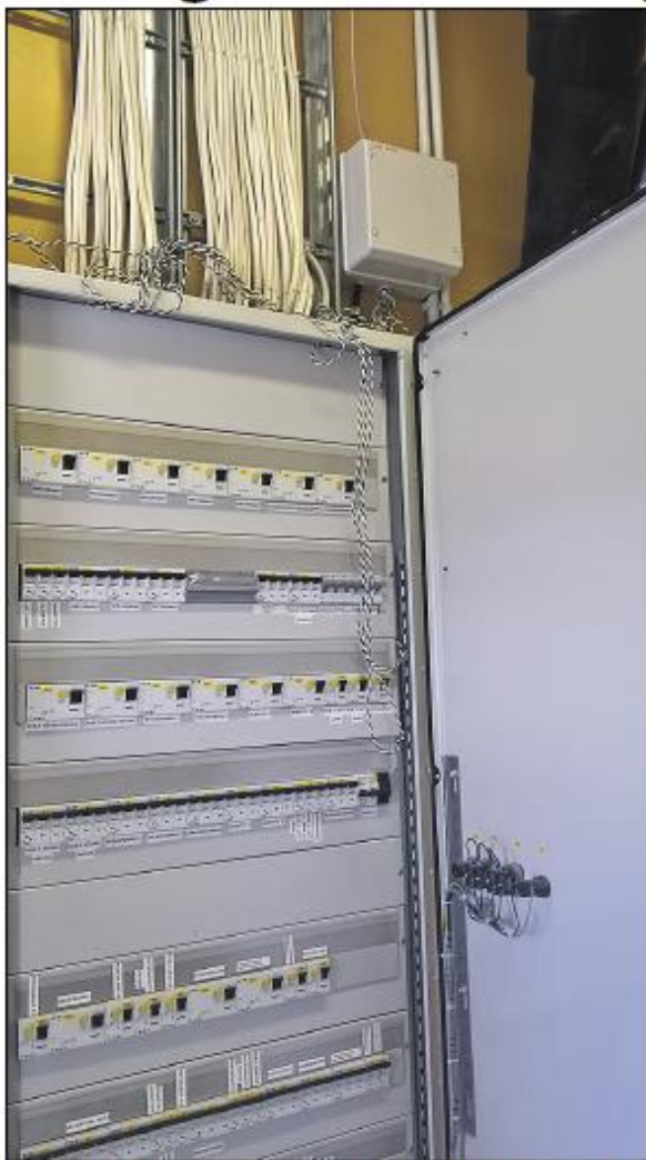
Mätaren installerad i elskåpet i den nya ladugården kan avläsas via nätet i realtid.
