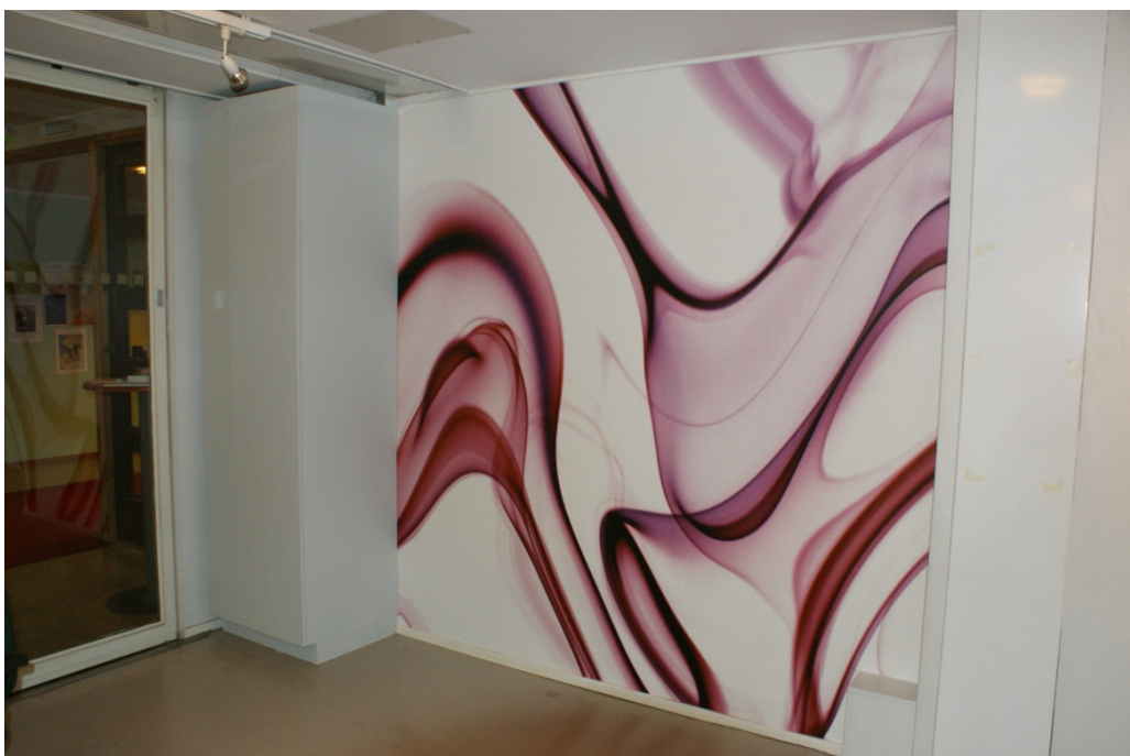
Fondväggen, samt inbyggt elskåp
