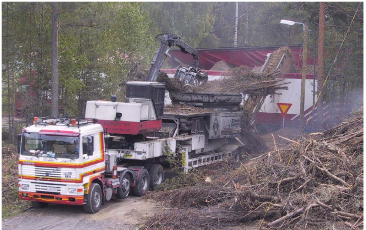
KUVA 1. Kantojen murskauksessa käytetty kaukalomurskain (kuva: UPM-Kymmene Metsä).
