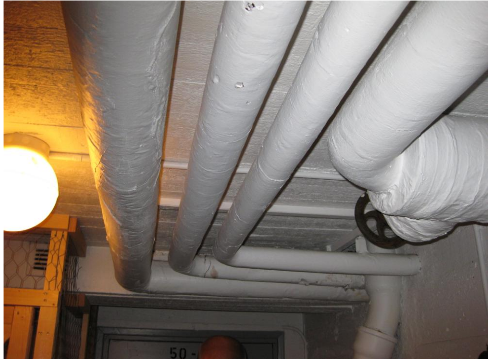
Kuva 4. Asbestia on käytetty runsaasti putkistojen eristyksissä
