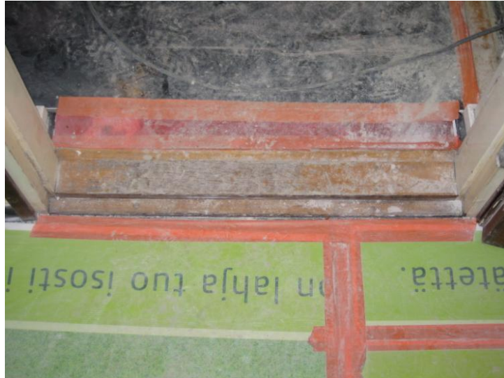
Kuva 20. Kynnys on vaurioitunut kovan kulutuksen takia
