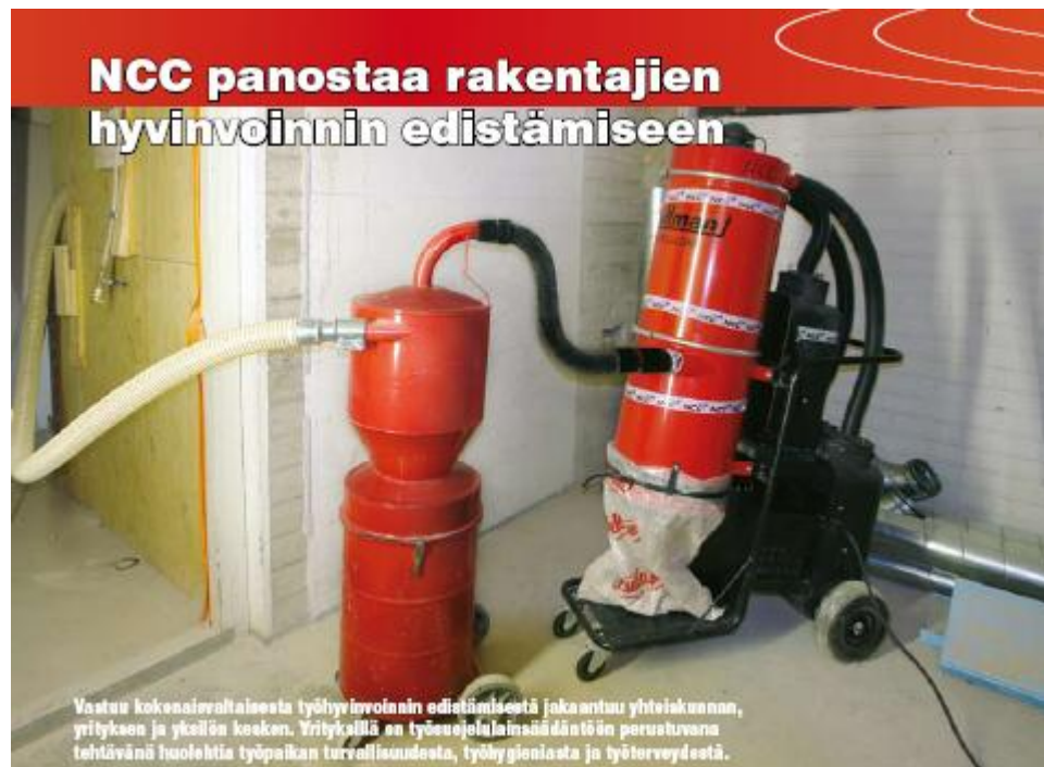
Kuva 11. Keskuspölynimuri, joka oli käytössä NCC:n Siilitien työmaalla /8/
