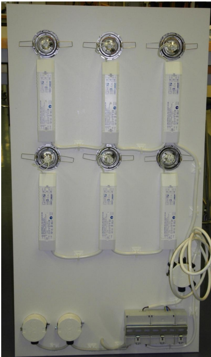
Kuva 43. EIB/KNX-väyläohjauslaitteisto takaa. Ylhäällä kuusi valaisinta ja DALI-liitännälaitetta, niiden alla oikeassa reunassa jakokorasia ja sähkönsyöttö (kaapeli ja pistotulppa), vasemmalla alareunassa kaksi kojerasiaa väyläliitännäyksiköille, keskellä NOMAKin läpivienvi päivänvalo/lämpötila-anturille ja oikeassa alareunassa EIB-laitteet: EIB/DALI-väylämuunnin, virtalähde ja USB-liityntä.
