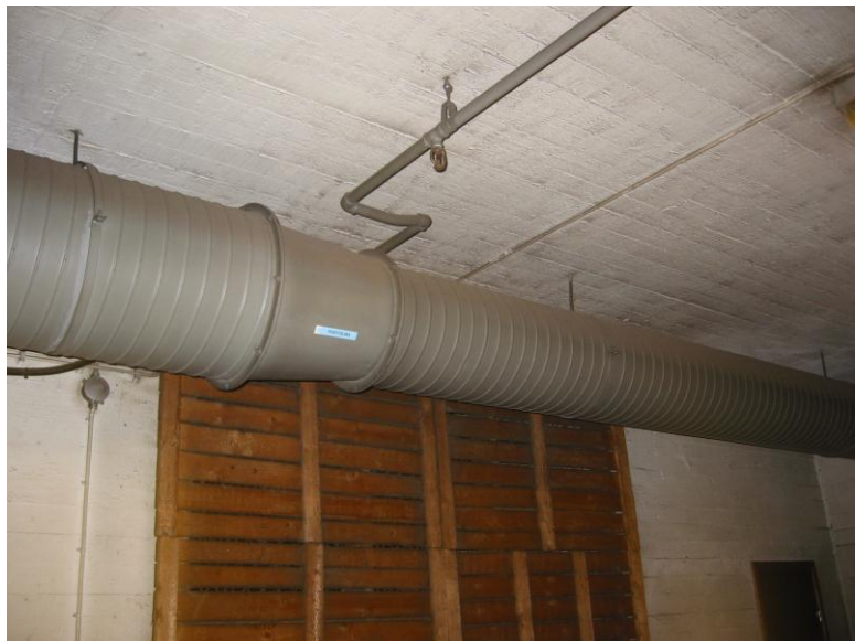
Kuva 15. Poistoilmakanava ja Sprinklerijärjestelmä.
