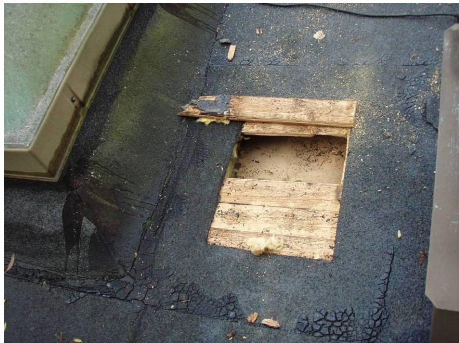
Kuva 6, Alusrakenteena toimiva ponttilaudoitus on lahonnut poikki kattokuvun vieressä /20/.
