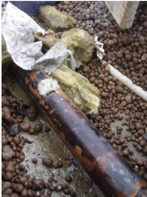
Kuva 30, Vettä oli kerros myös kantavan ontelolaatan pinnalla, josta se oli element-tisaumojen kautta päässyt vuotamaan alapuolisiin tiloihin.
