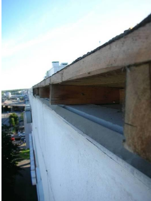
Kuva 9, Katon vedeneristekermi päättyy otsapinnalla liian lyhyenä, jolloin räystäspel- lin alle pääsevä vesi voi valua imeytymällä seinän sisälle /20/.
