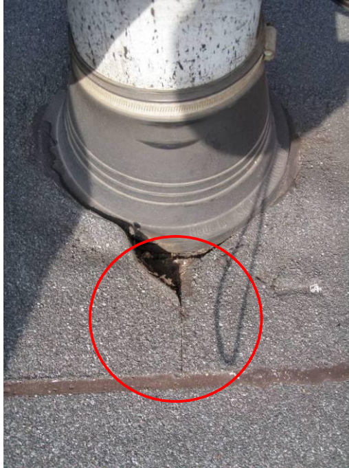
Kuva 15, Vaurioitunut läpiviennin toteutus /20/.
