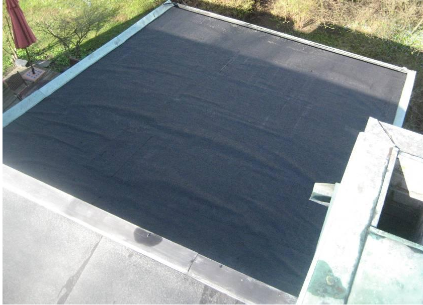
Kuva 16, Havaintoa tarkentava kuva korjaustarveselvityksestä, pintakermi on kuprulla /9,s.9/.
