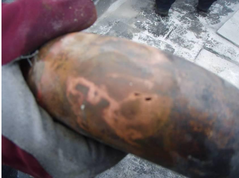
Kuva 28, Vaakaputkiston mutkasta paljastui reikä, josta vesi oli kaivon saumakohdan lisäksi päässyt vuotamaan rakenteisiin.
