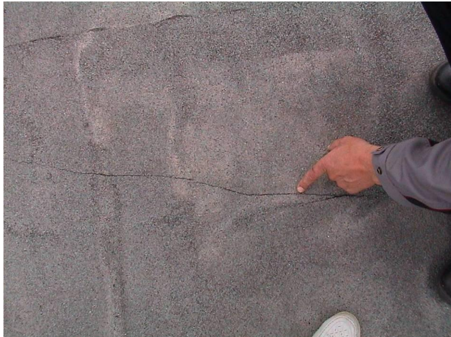
Kuva 7, Halkeamia poimuttuneessa kermissä./20./
