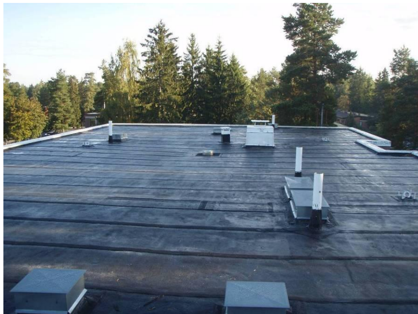
Kuva 25, Kermi oli edelleen hyvässä kunnossa. Katolla ei esiintynyt lammikoitumista.
