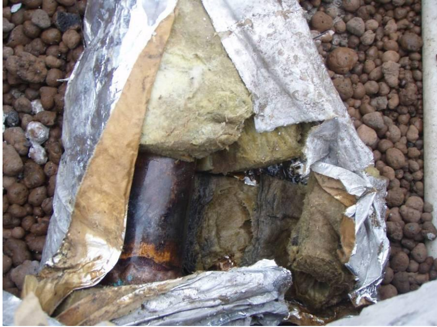
Kuva 29, Putken eristeet olivat läpikastuneet vuotojen seurauksena.
