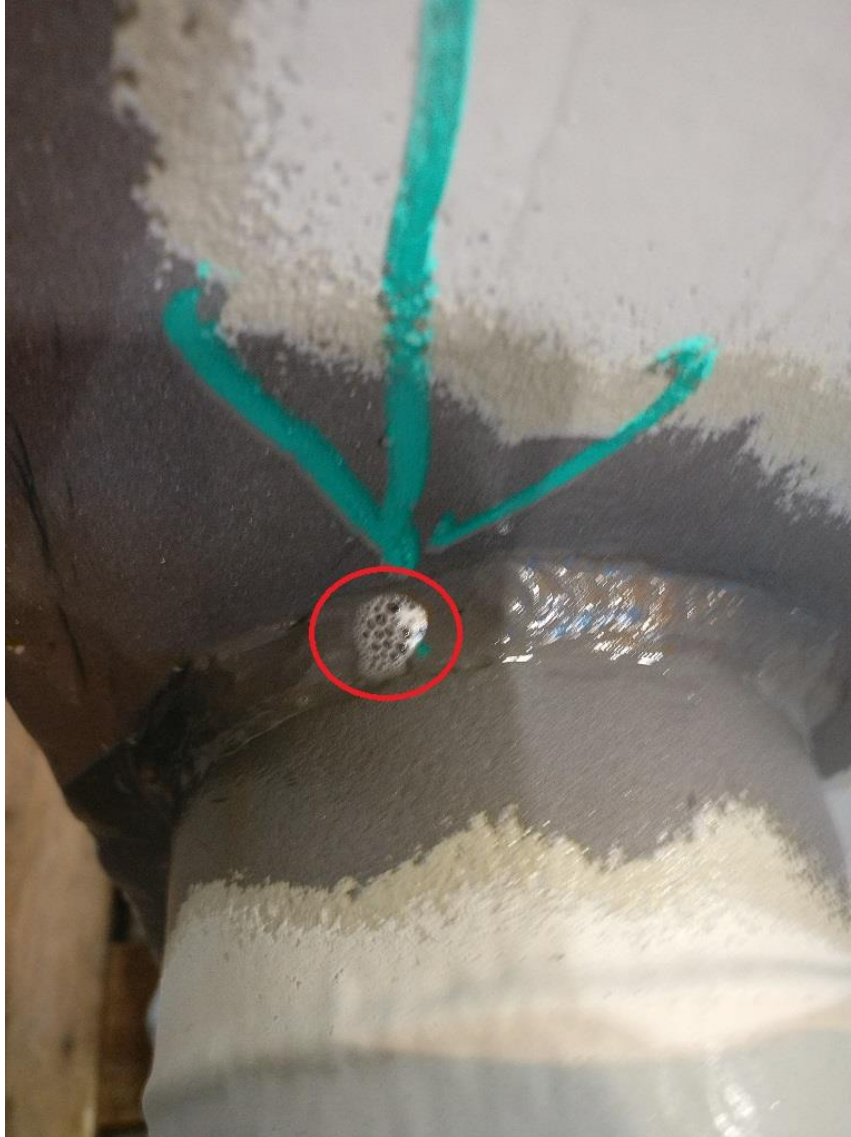
KUVA 4 Paineilmatiiveystestillä havaittu vuoto
