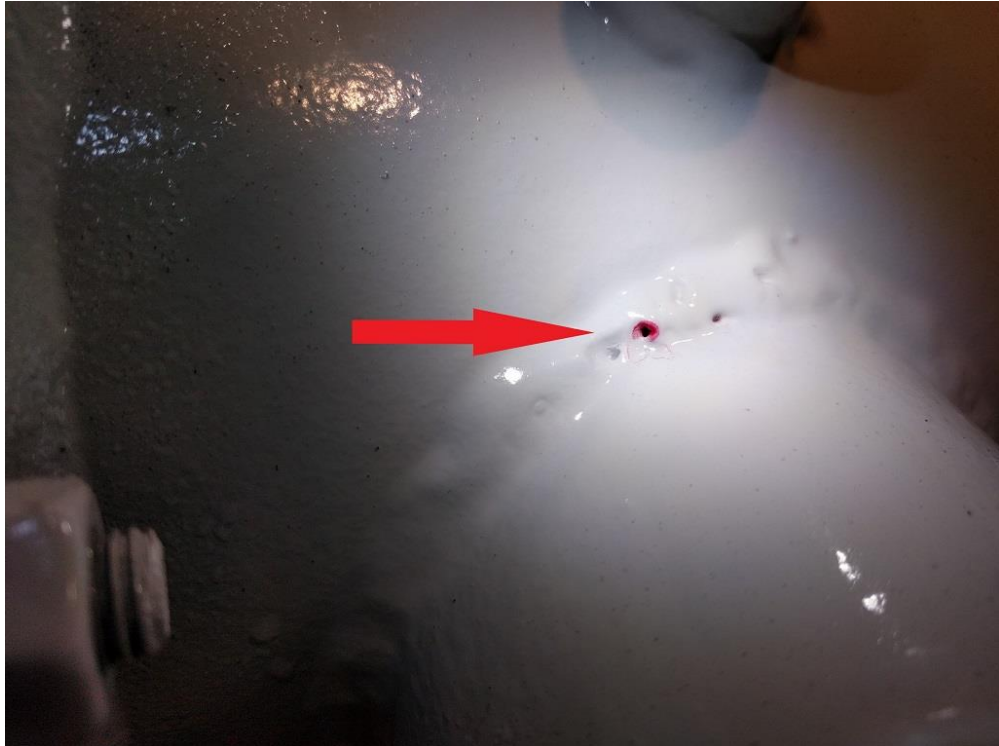
KUVA 3 Tunkeumanestetestillä havaittu vuoto
