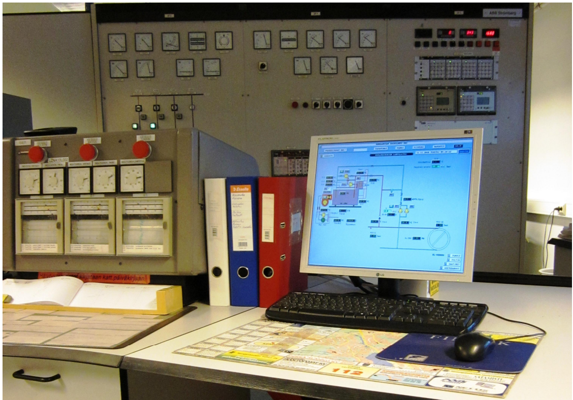
Kuva 5. Kankaanpään kaukolämpölaitoksen valvomossa etualalla on MiSO-kaukokäyttöjärjestelmän ohjauspäätte laitoksen ulkopuolella, kauempana olevien kohteiden valvontaa varten. Vasemmalla näkyvät laitoksen hätäseis-painikkeet ja taustalla ABB Strömbergin toimittama ohjaustaulu, josta generaattoria ohjataan.
