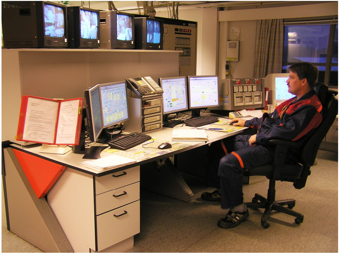
Kuva 2. Kankaanpään kaukolämpölaitoksen valvomossa ohjataan Alcont-järjestelmällä voimalaitoskattilaa ja kaukolämmön tuotantoa. Videovalvonnalla seurataan mm. polttoainekuljettimia. Operaattorilla on ohjeistuksen mukainen turvapainike kaulassa.
