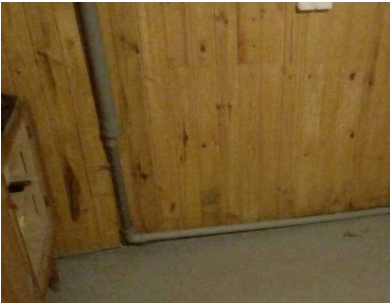
Kuva 8. Suihkutilojen viemäriputki kulkee kellarikerroksen lattiapinnassa - (Kankkunen 2019-03-15)
