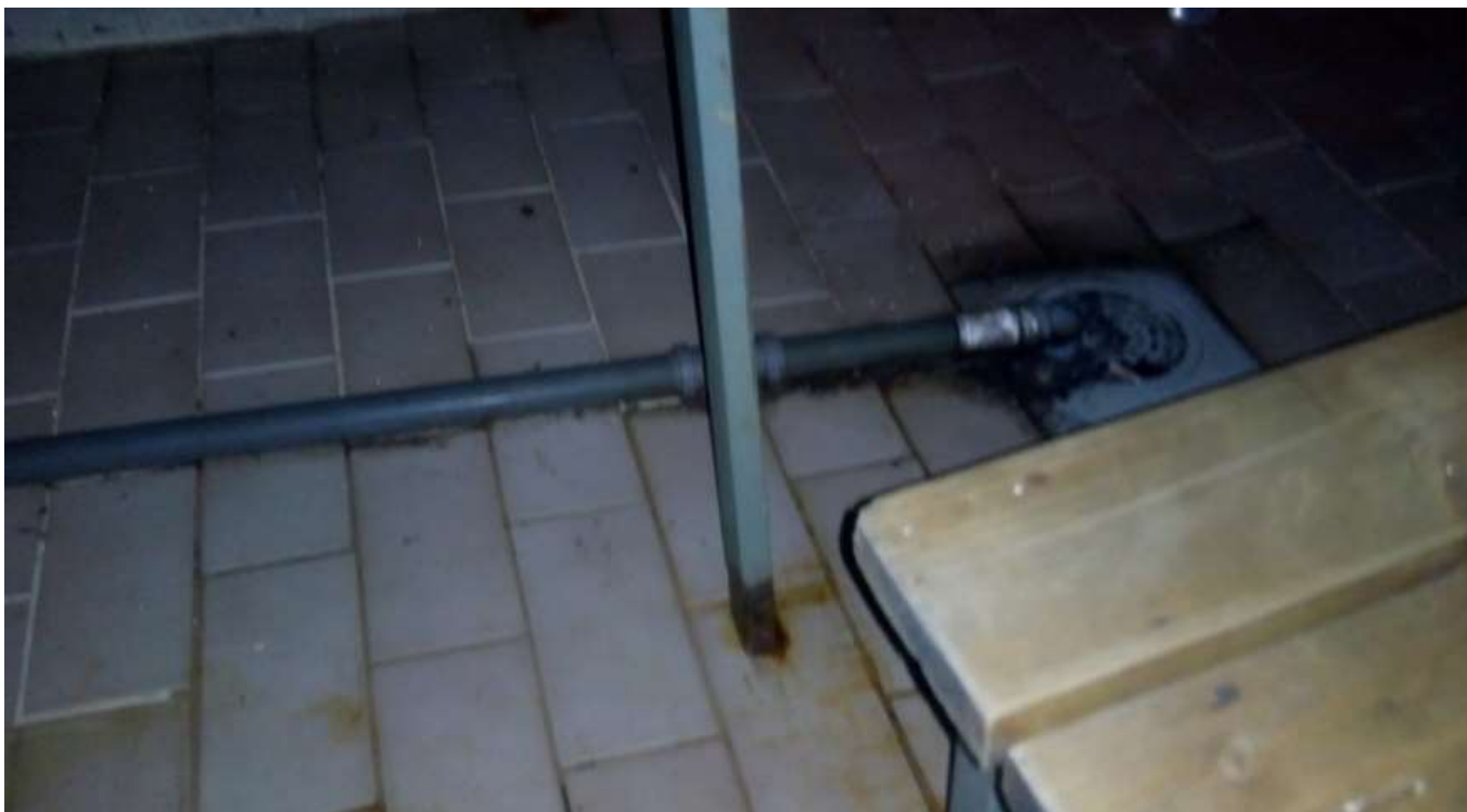
Kuva 9. Suihkutilojen viemäriputki päätty kellarikerroksen saunatilán lattiakaivoon - (Kankkunen 2019-03-15)
