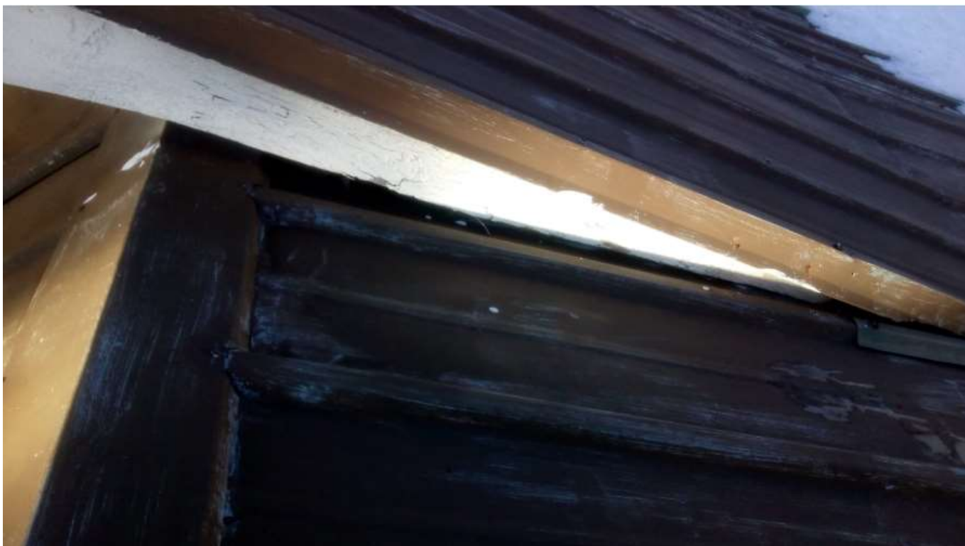
Kuva 10. Valokuva alkuperäisen rakennuksen räystäään törmäämisestä laajennusosan kattolappeeseen - (Kankkunen 2019-03-15)
