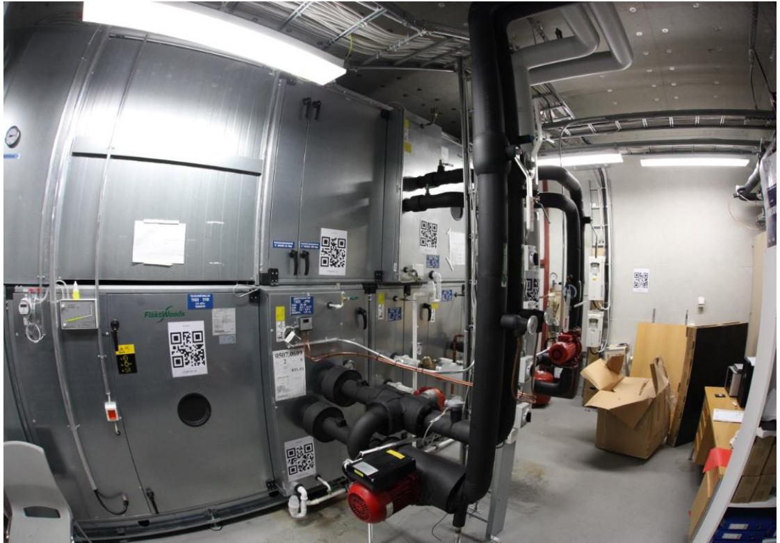
Kuvio 4. IV-tilassa sijaitseva ilmastointikoneikko.
