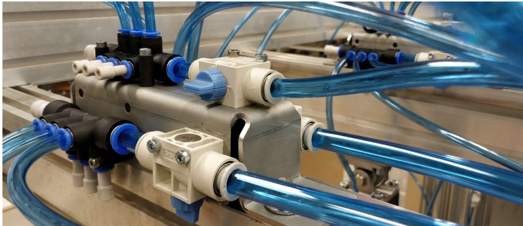
Kuva 17. Paineilma- ja alipainelinjojen jakotukit sekä 3-tieventtiilit sylinterien tukipalkkien yläpuolella, kiinnitettynä suunniteltuun kappaleeseen.
