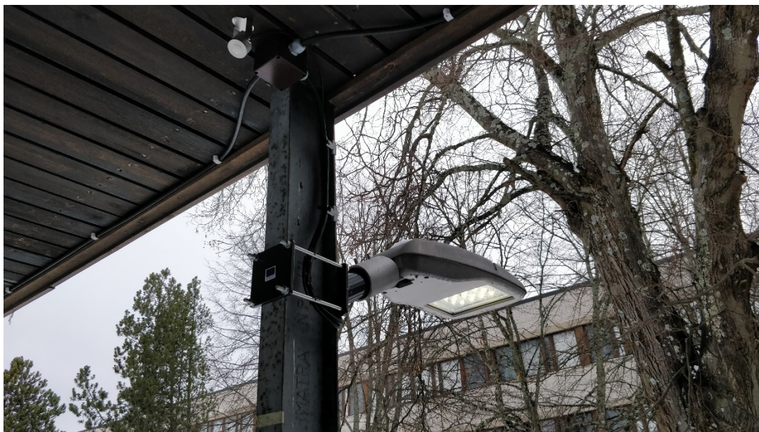
Kuva 37. LED-valaisin asennettu Opistotien kampuksella.
