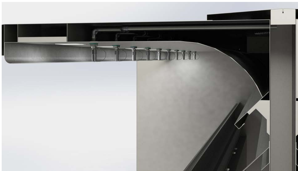
Kuva 29. ANSUL-suuttimet putkituksineen huuvan katto-osassa (Ryynänen 2017)
