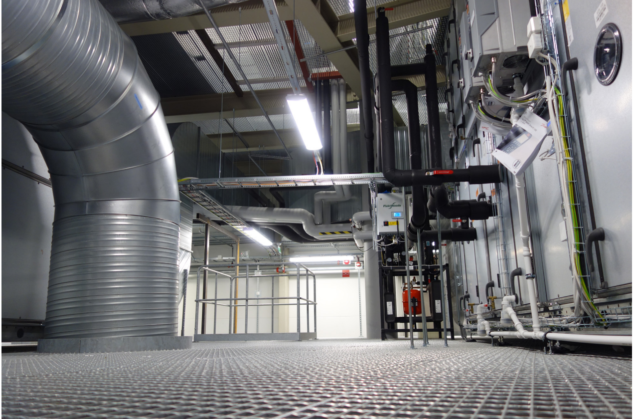
Kuva 28. Ilmanvaihtuhuoneet on suunniteltu ja toteutettu tilaviksi ja opetukseen soveltuviksi.
