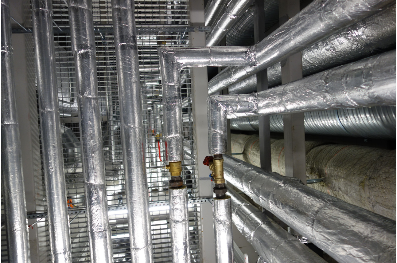
Kuva 27. Kanavisto ja putkiasennukset ovat myös opiskelijoiden tutkittavissa.
