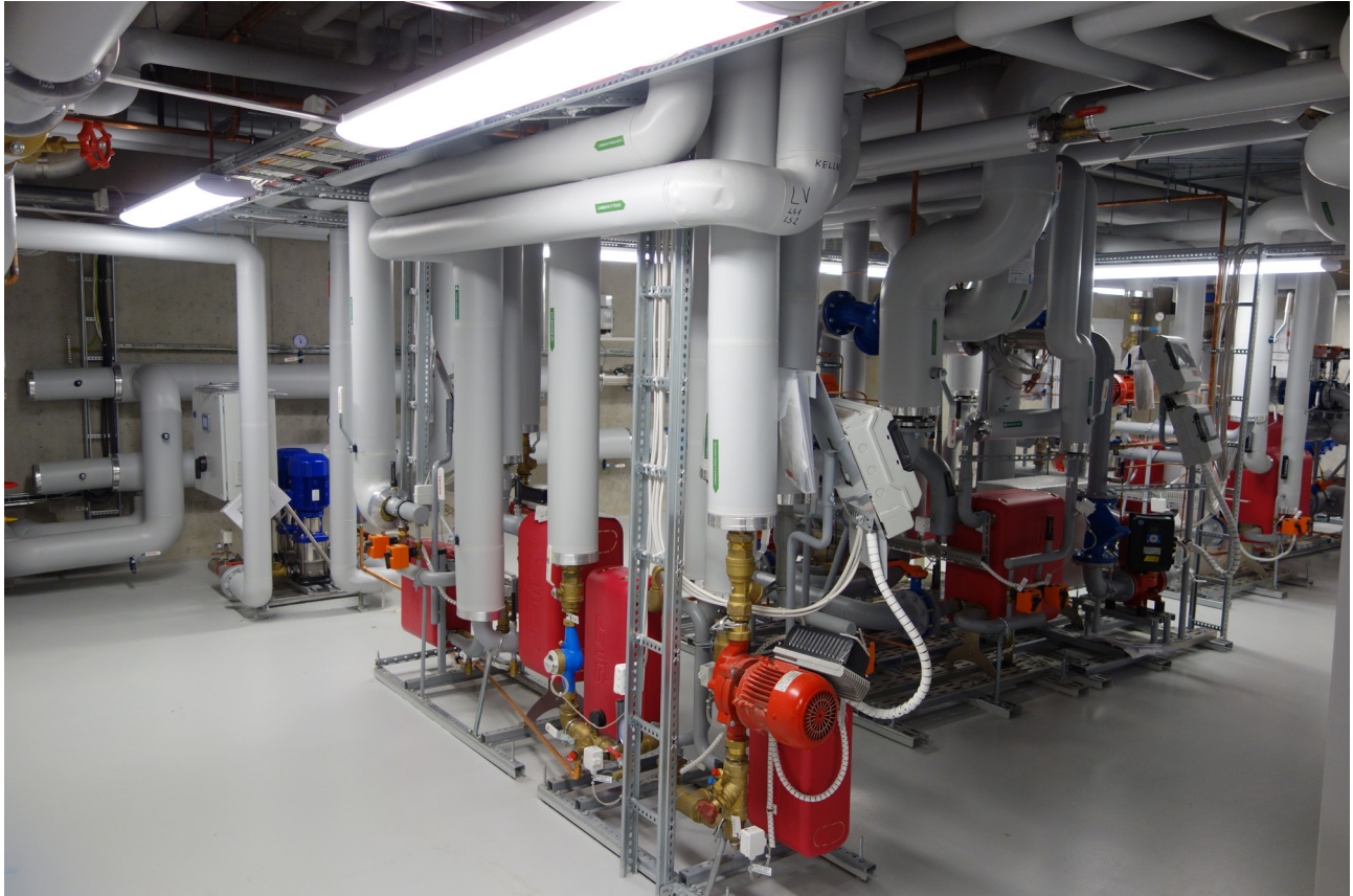
Kuva 2. Lämmönjakohuone toimii myös opetuskäytössä.
