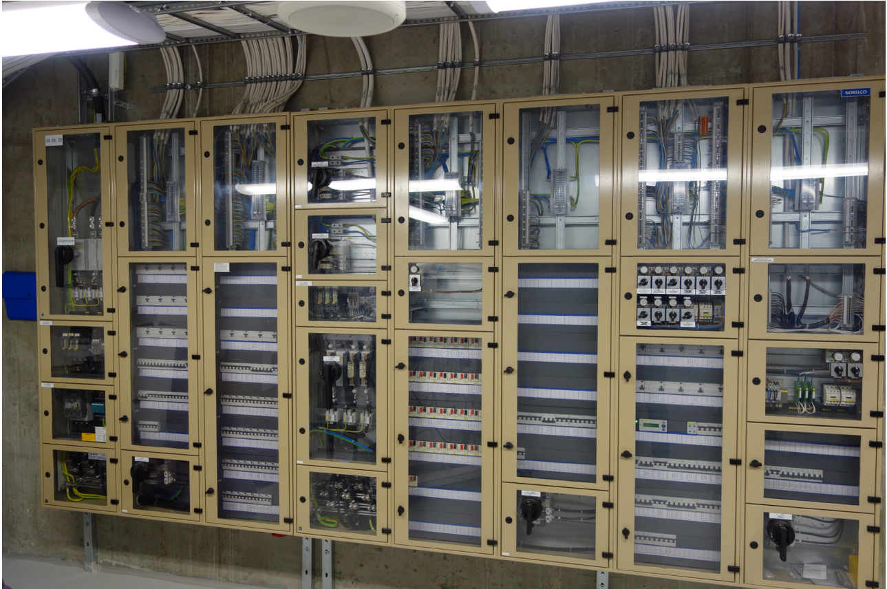
Kuva 26. Myllypuron kampuksen sähkökeskusasetukset on tehty läpinäkyviksi ja opetukseen sopiviksi.
