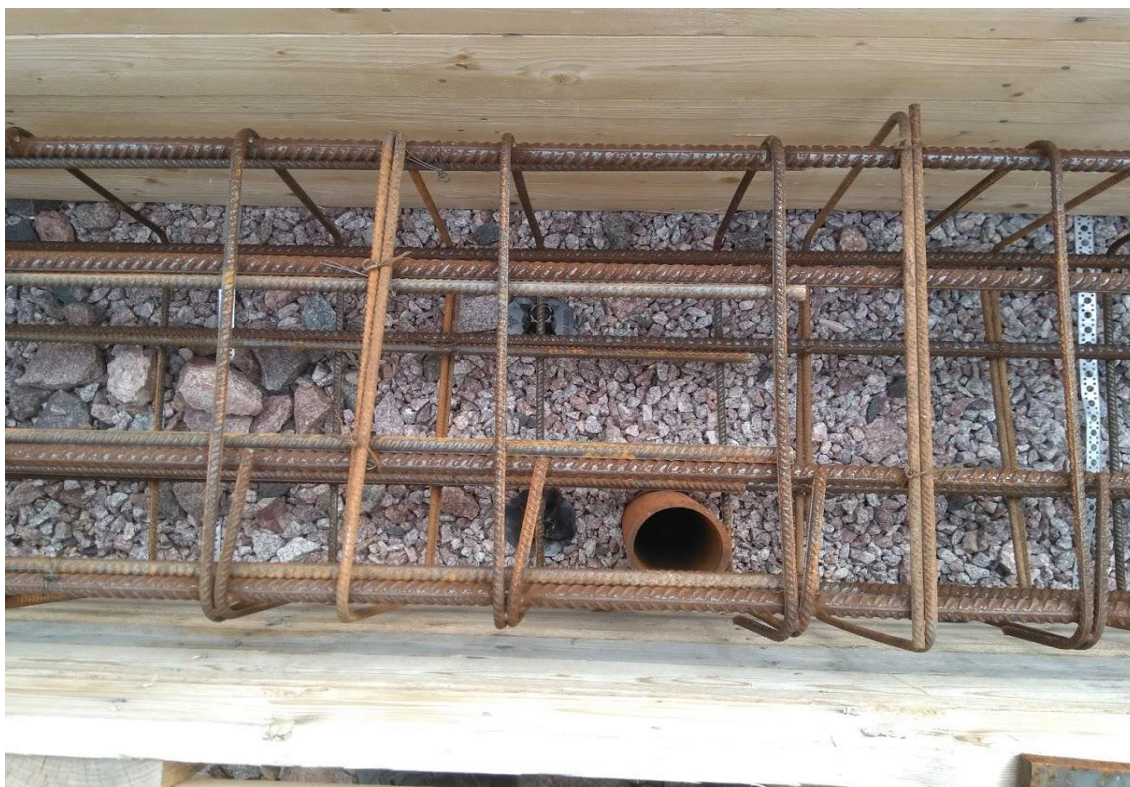
Kuva 3. Teräspaalun sijainti poikkeava. Pääteräkset sopivat menemään paalun ohitse paalun ja muotin välistä. Muutoksia ei tarvinnut tehdä.
