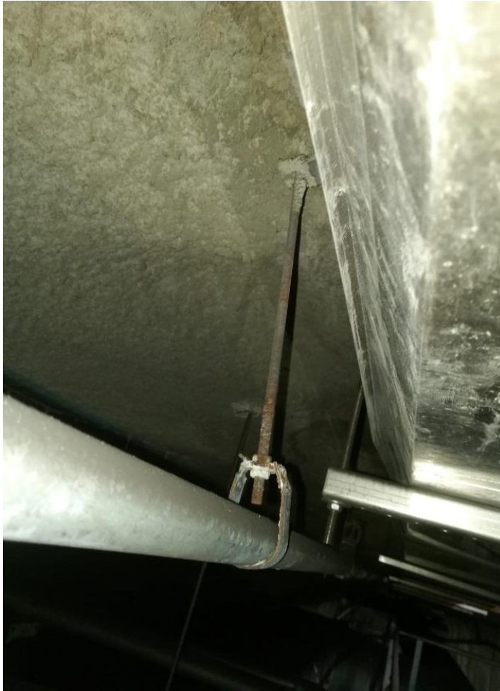
Kuva 4. Vanha, huonokuntoinen putkikannake.
