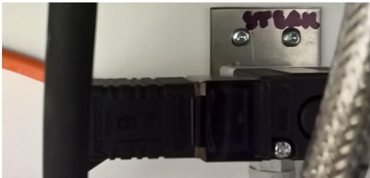
Kuva 13. Reaktoritankin höyrösyöttöventtiilin pneumaattinen kytkin.
