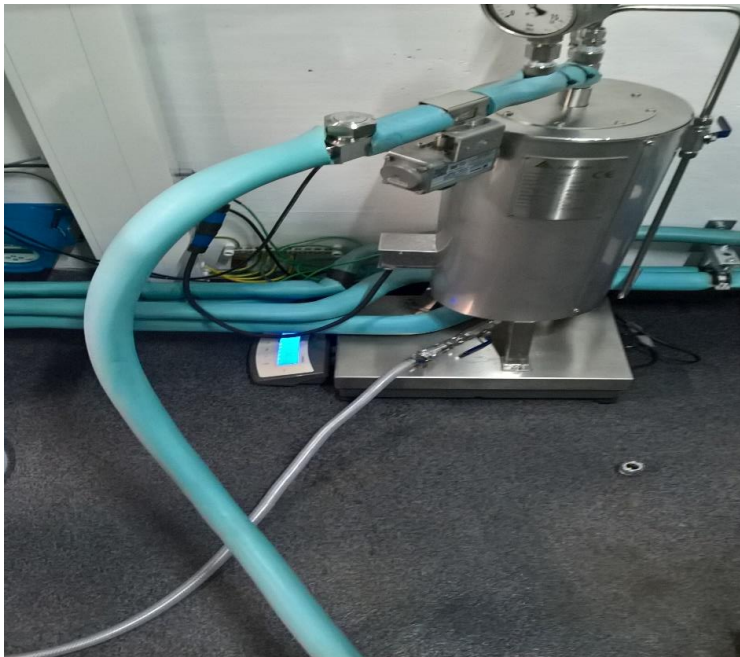
Kuva 28. Laitteiston höyrygeneraattori, jota ollaan tankkaamassa vedellä.
