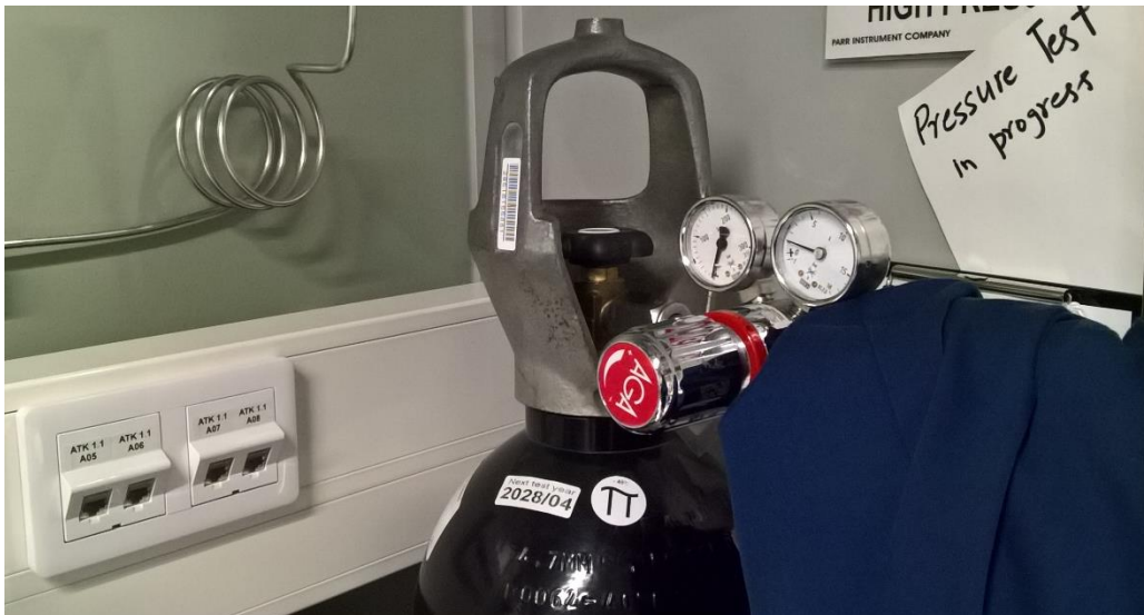
Kuva 9. Inerti N 2 -kaasun säiliö ja sen säätöventtiilit. Kaasusäiliö aukeaa kiertämällä päällä olevaa venttiiliä vastapäivään.
