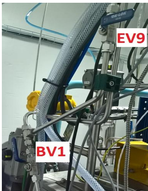
Kuva 15. Reaktoritankin kaasun poistovenitit.
