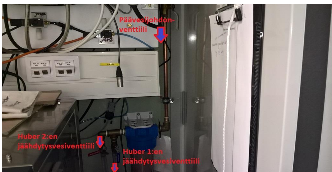
Kuva 12. Huber-lämmittimen vesijohdot ja niitä ohjaavat venttiilit.
