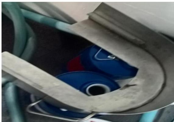
Kuva 32. Reaktoritankin suojapelti. Ohjaukiskokot kotelon sivuilla on asennettu jälkikäteen.
