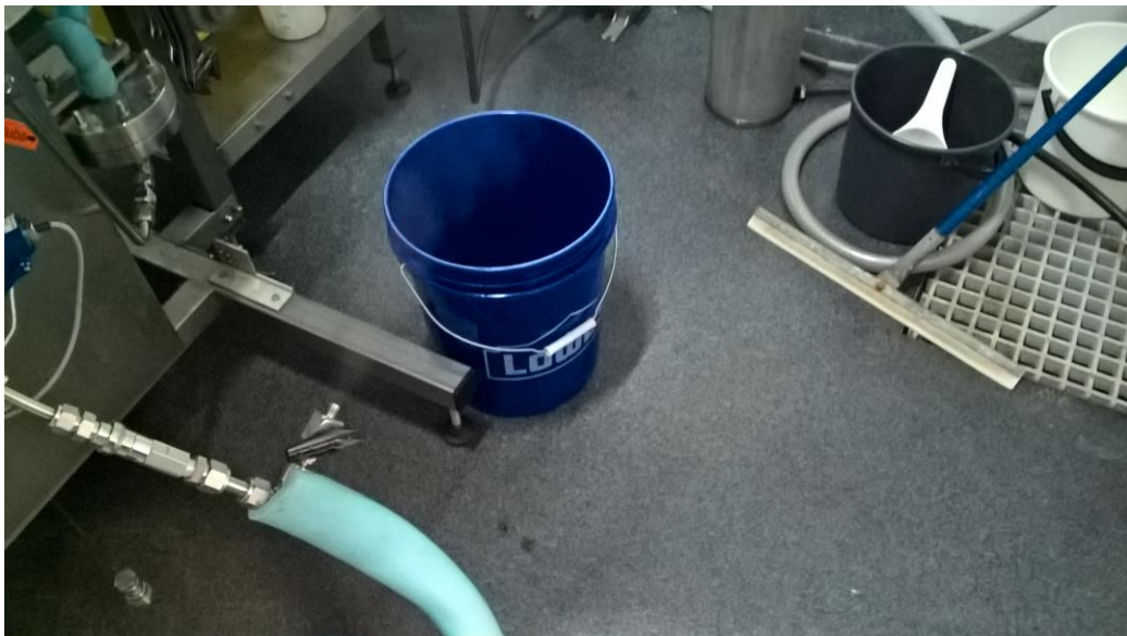
Kuva 31. Höyryä poistetaan venttiilin SG3 kautta.
