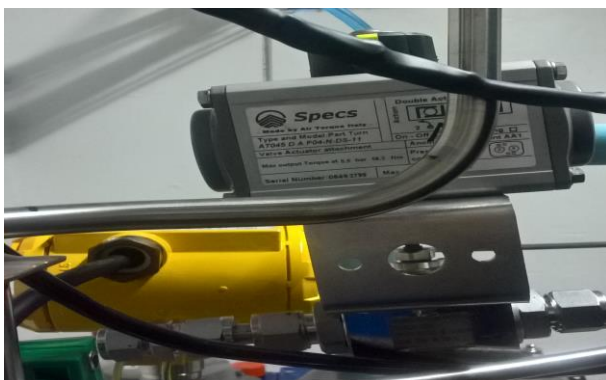
Kuva 22. Reaktoritankin pneumaattinen poistiventtiili.
