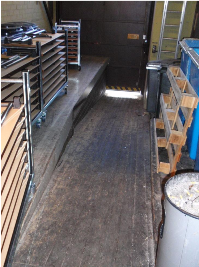
KUVA 1: Lastauslaituri kadun suuntaan, ennen siivousta.
