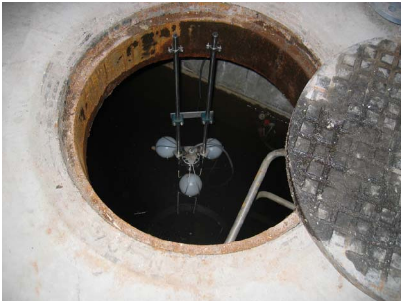
Kuva 30. Öljyä vedessä mittausta ns. kattokruunulla. Säiliön katossa on miesluukku asennusta ja huoltoa varten sekä hitsatut ohjaimet, jotka pitävät mittalaitetta paikallaan.
