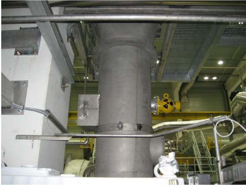
Kuva 26. Radiometrinen pinnankorkeuden mittaaminen. Laitteet eivät ole kosketuksissa prosessiaineen kanssa. Kuvasta havaitaan myös vastaanottimen ympärillä oleva suoja.
