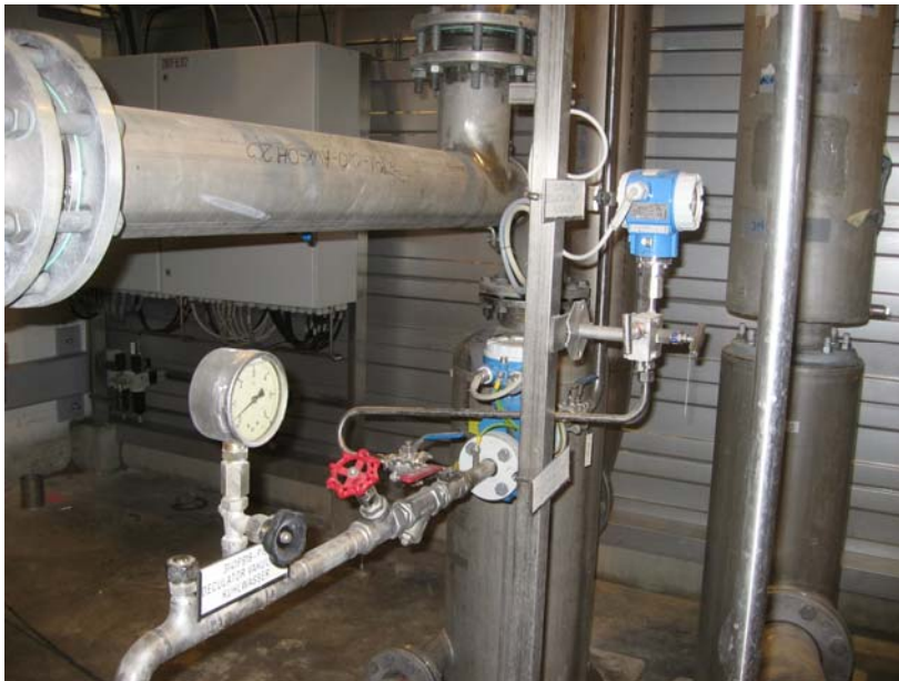
Kuva 4. Kuvasta havaitaan liitännän sulkuventtiili ja impulssiputkitus sekä kuvassa vasemmalla paikallinen painemittari.
