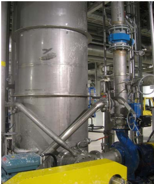
Kuva 19. Säätöventtiili tulisi sijoittaa magneettisen määrämittarin jälkeen. Kuvassa poikkeustapaus, MC-pumppaus, jolloin venttiili on asennettu MC-pumpun laippaan ja magneettinen määrämittari on asennettu venttiilin jälkeen.
