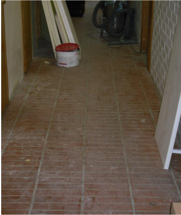
Kuva 16. Työt käynnissä ja imurointi on tekemättä.
