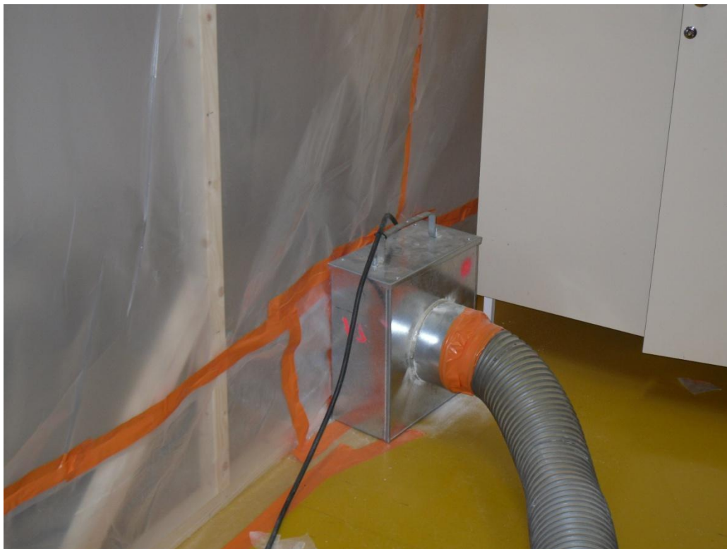
Kuva 5. Alipaineistus on tehty suoraan ulos omalla poistoputkella.
