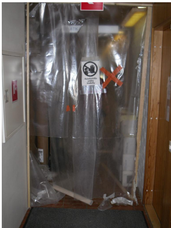
Kuva 15. Suojaseinä rikottu ja seinä on jätetty korjaamatta.
