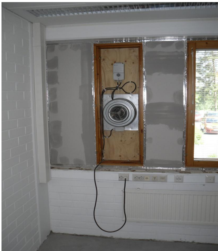
Kuva 8. Toimiston alipaineistus on toteutettu kanavapuhaltimella.
