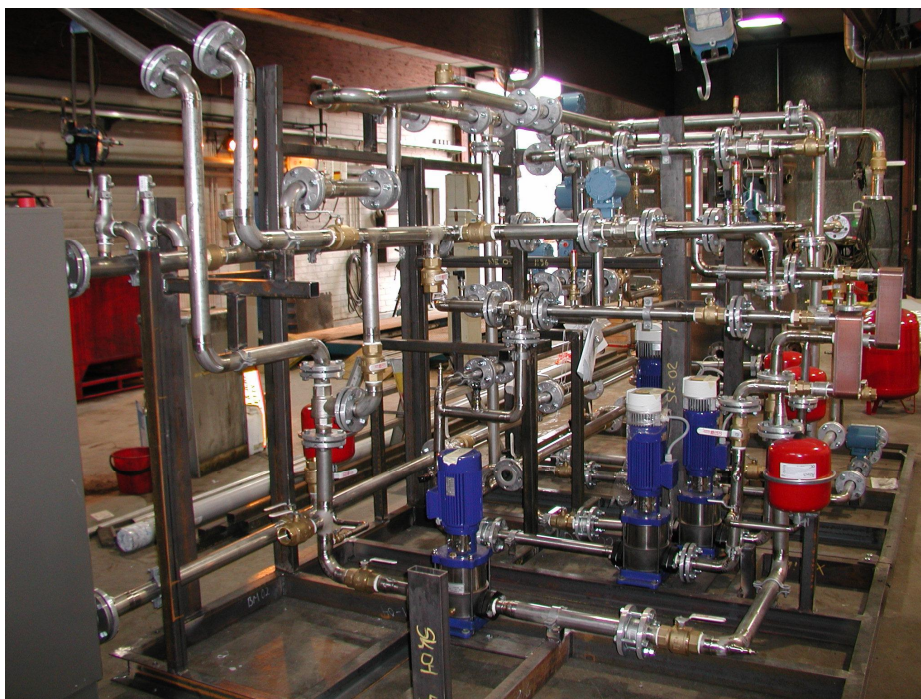
KUVA 39. Rakenteilla oleva testausympäristö.
