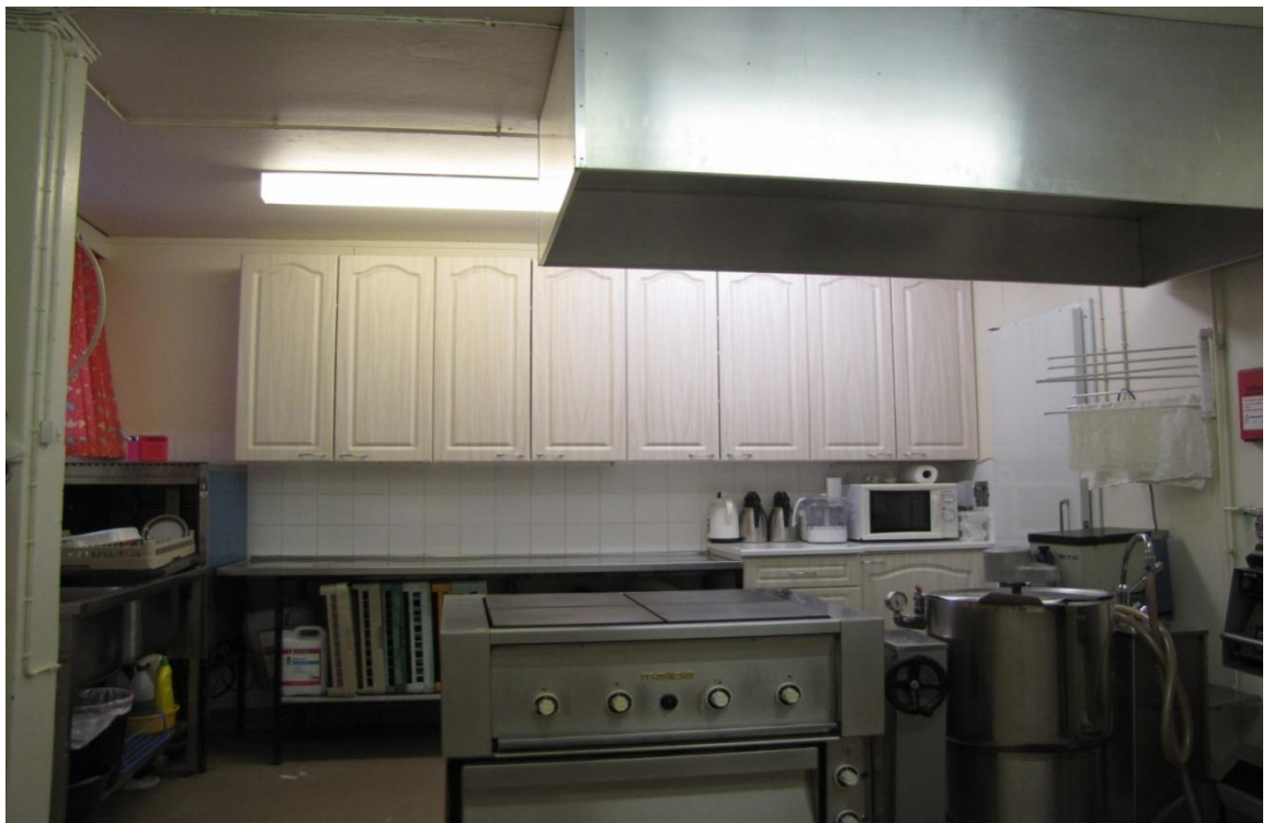
Kuva 11. Käylän leirikeskuksen keittiön ruoanvalmistuspisteen kohdepoisto.
