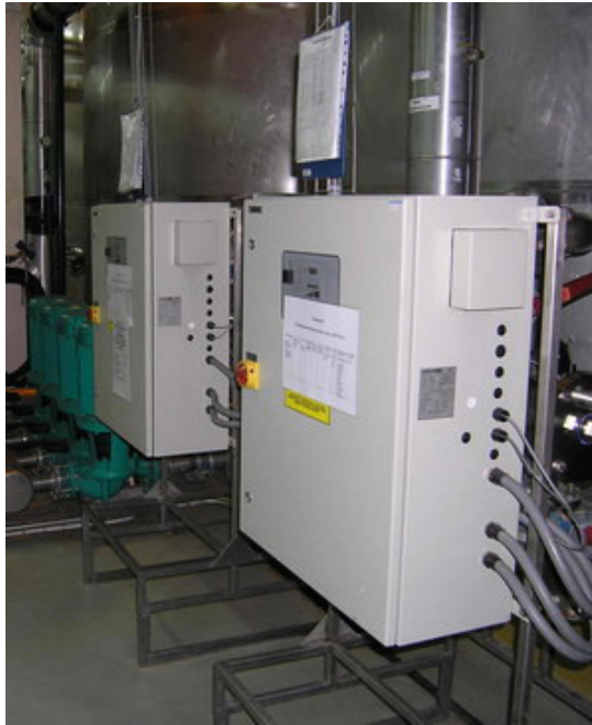
Kuva 18. Asennettu käynnistin laivassa
