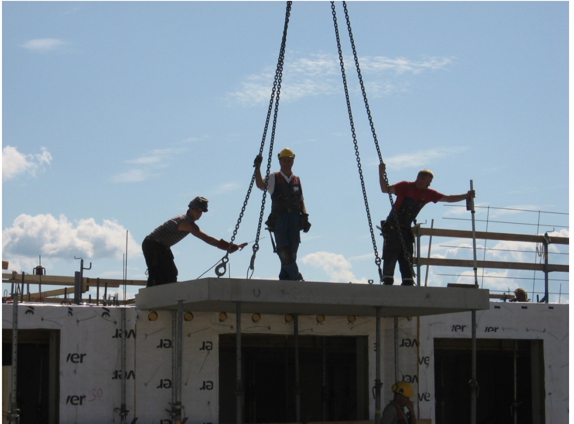
Kuva 2. Nostosta aiheutuva työturvallisuusriski.
