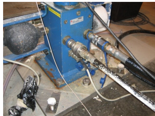
Kuva 9. Hydrauliiikkaletkut ja mittausliitin.
