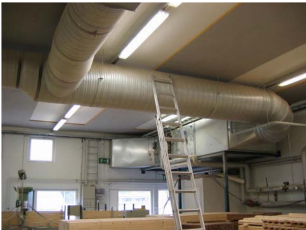
KUVA 14. Ukonilma on sammuttanut tuloilmapuhaltimen, mutta säätökeskus ei anna siitä ilmoitusta.
