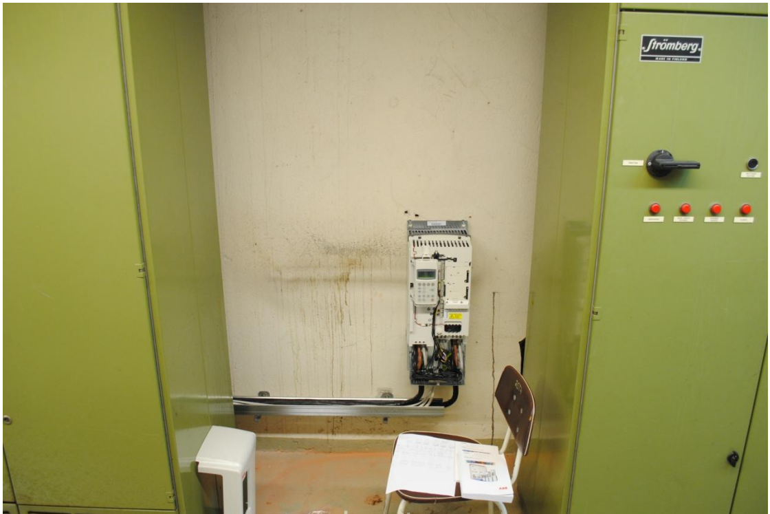
KUVA 12: Imusuodin 4 ABB:n ACS800- sarjan taajuusmuuttaja asennettuna sähkötilaan. /5/
