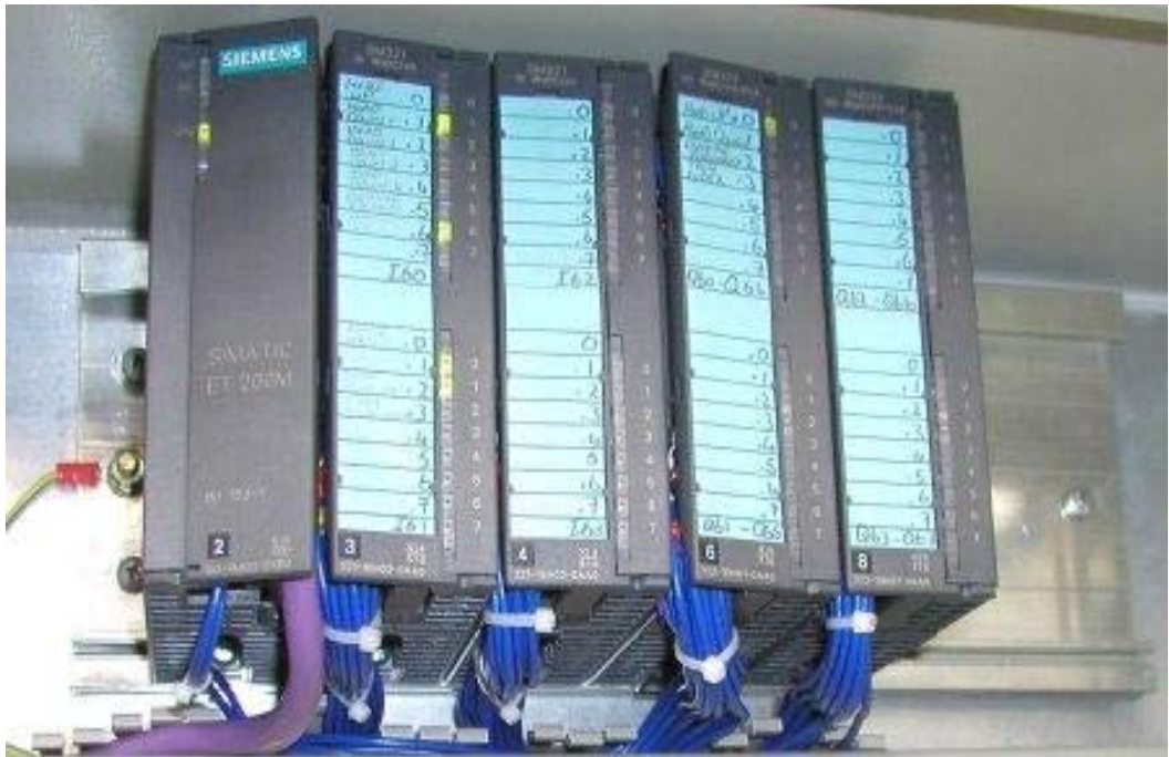
KUVIO 12. Siemensin ET200M-hajautusyksikkö asennettuna keskuksen.
