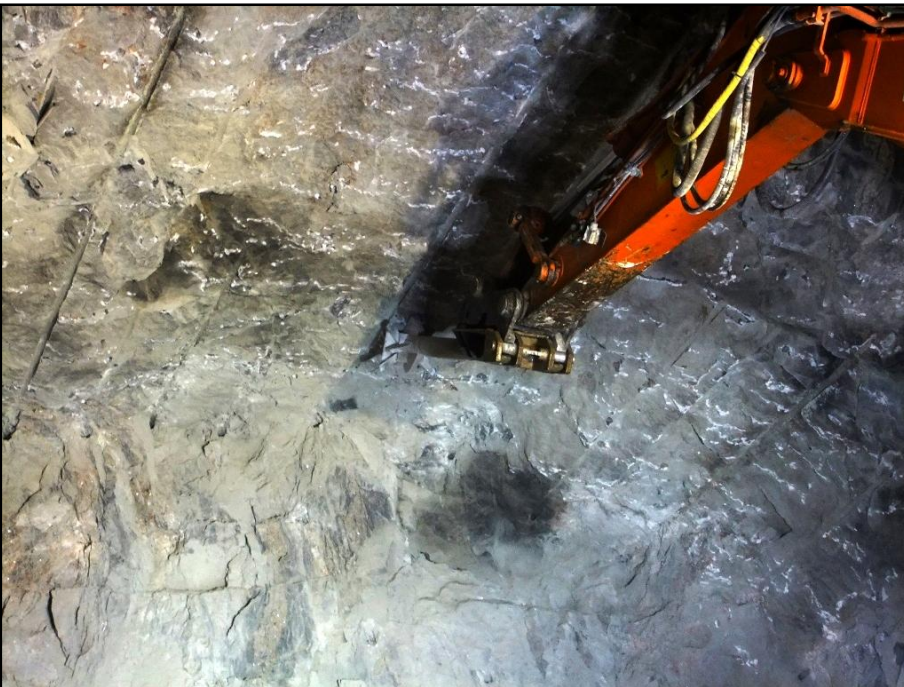
Kuva 32. Räjätetyn katkon katon rusnausta. Työskentely rusnatulta alueelta.
