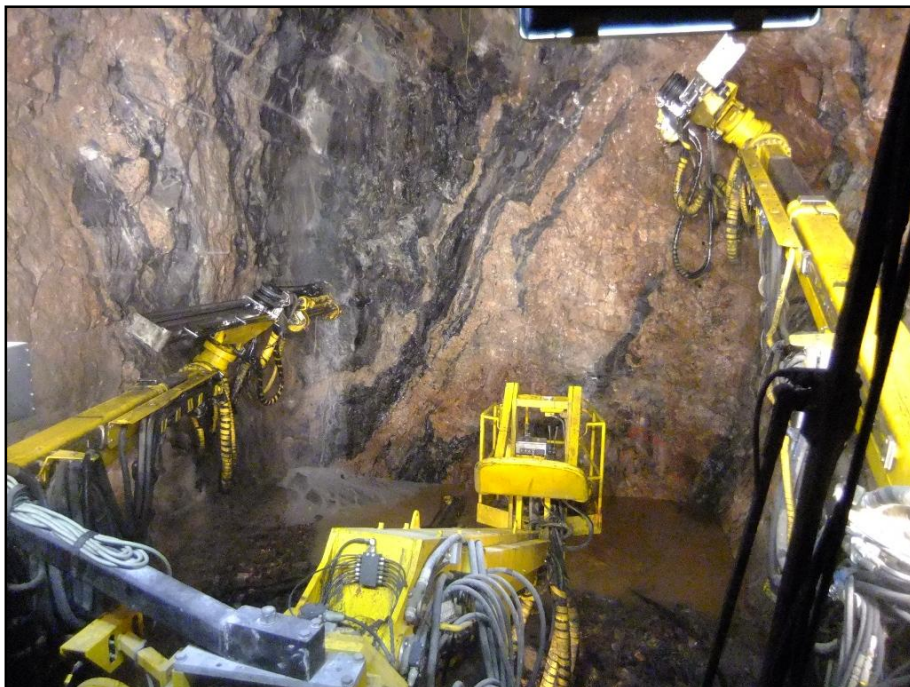
Kuva 35. Ei ylimääräistä kiviainesta perässä porauksen aikana. Ei toimintaa puomien alueella. Poistovesiletkut ehjät.
