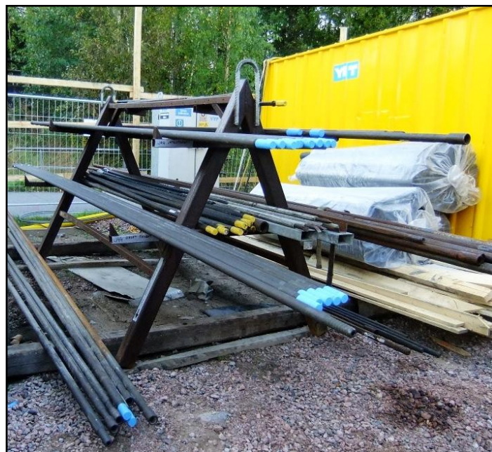
Kuva 19. Porakanget säilytyksessä telineessä, eikä maassa, jossa ne olisivat vaarassa rikkoutua.
