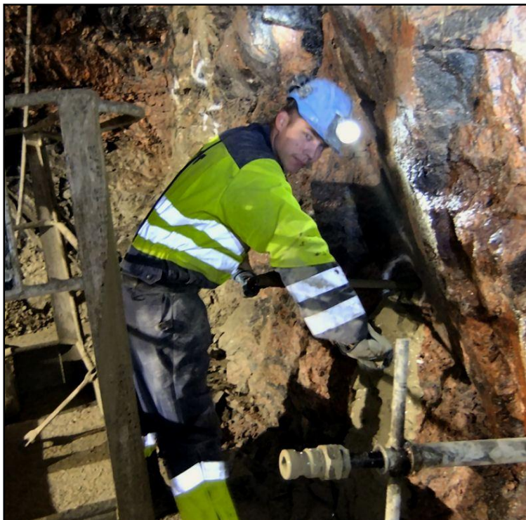
Kuva 2. Ei suojalaseja injektoitaessa → väärin-havainto.
