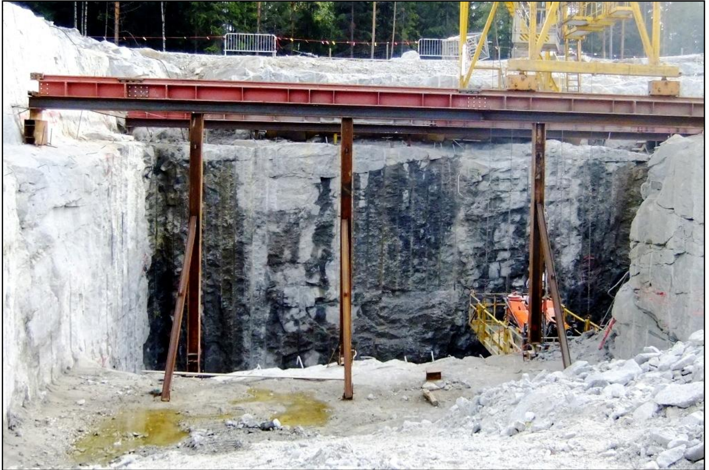
Kuva 38. Kuilun reunoilta puuttuu kaiteet. Putoamisvaara.
