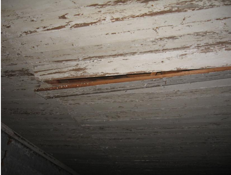
Kuva 10. Myös huoneessa kuusi kattolautoja on irronnut pontistaan.
