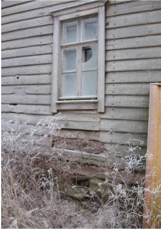
Kuva 5. Pohjoispäädyn ikkunan alta on kivijalka sortunut.
