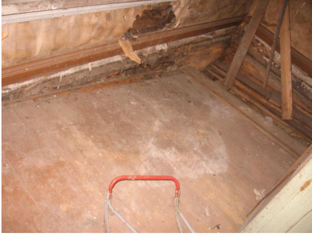
Kuva 6. Lattian kallistuma huoneessa numero 7.
