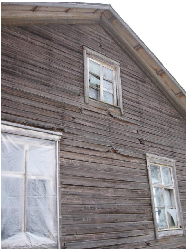
Kuva 7. Eteläpäädyn huonokuntoista vuorilaudoitusta.
