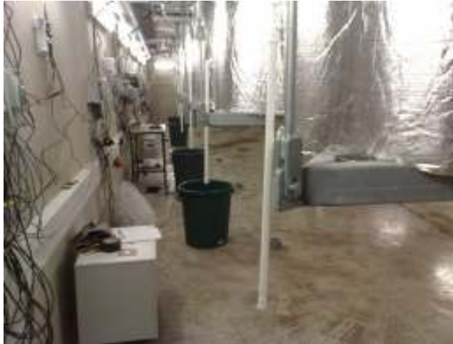
KUVIO 12. Osa vedestä kerätään näytteiksi ja osa tippuu suoraan lattialle. (Ryynänen 2010.)
