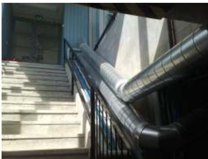
KUVIO 7. Tulo- ja poistoilmaputkistot rappukäytävässä. (Ryynänen 2010.)
